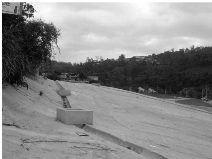
Figura 26 – Parte de tratamento de isolamento do antigo depósito de arsênio, na porção leste do terreno
