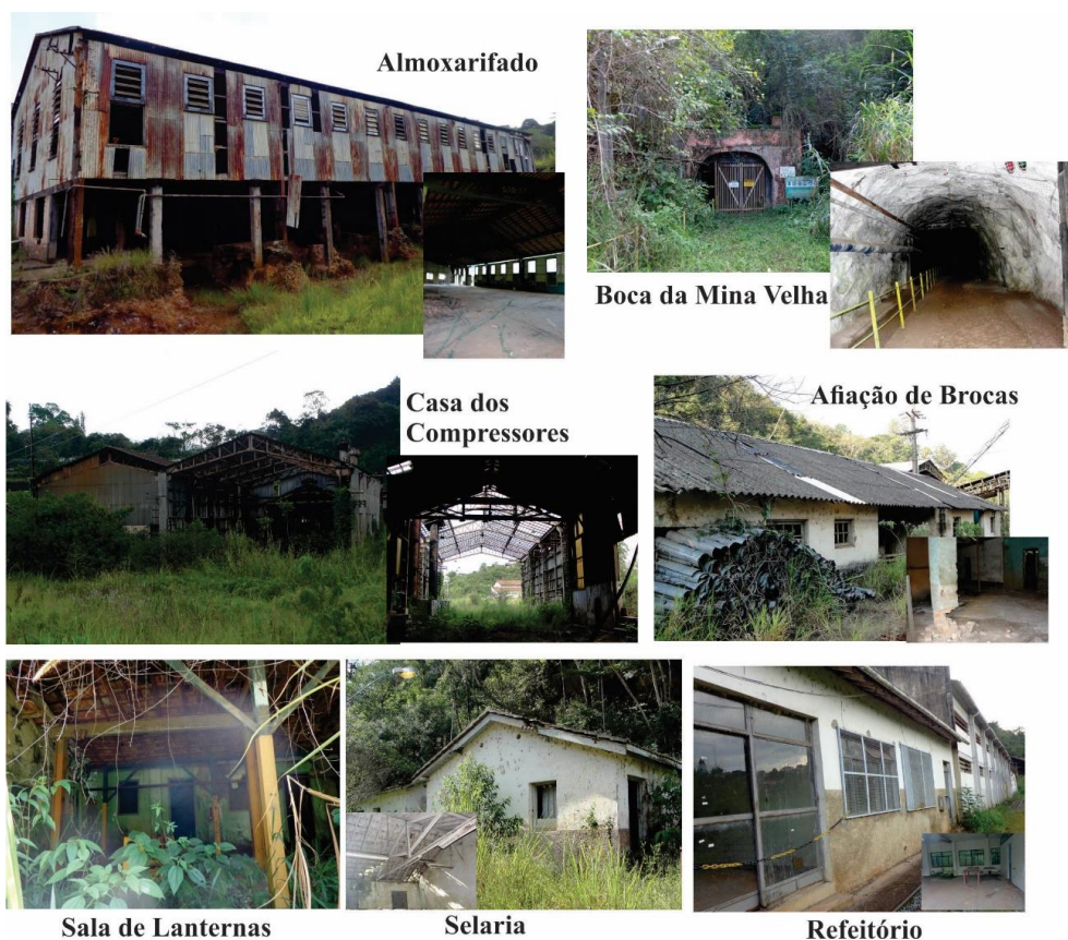
Figura 31 – Fotos dos bens inventariados em péssimo estado de conservação
