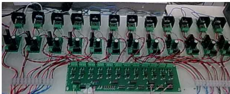
Figura 4.54: Detalhe Protótipo do CST em Ona Quadrada - topologia Multinível em Cascata - Trifásico - Inversores de Frequência e Condicionamento de sinais (demultiplexador)
