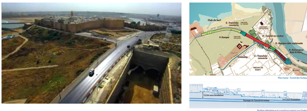
Figura 56 – Vista aérea da construção do túnel na estrada costeira d'al Marsa, a esquerda e planta e corte esquemáticos representativos do trajeto do túnel na região, a direita
