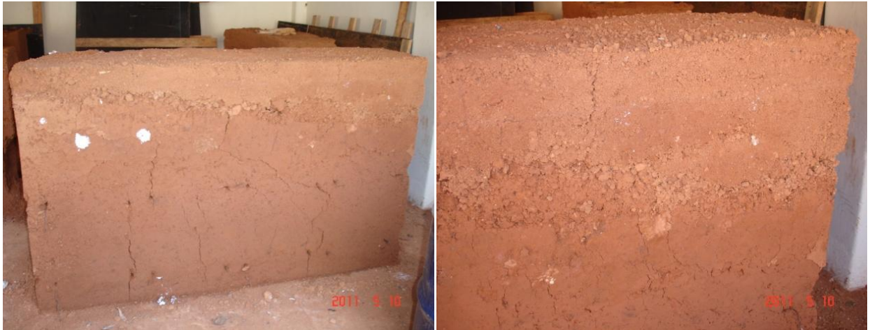
FIGURAS 58 e 59 – Painei 1 – Painei defeituoso
