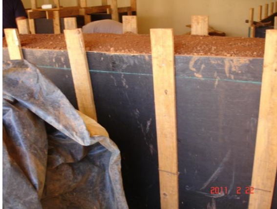
FIGURA 35 – Compactação do painel 1 – Painel defeituoso
