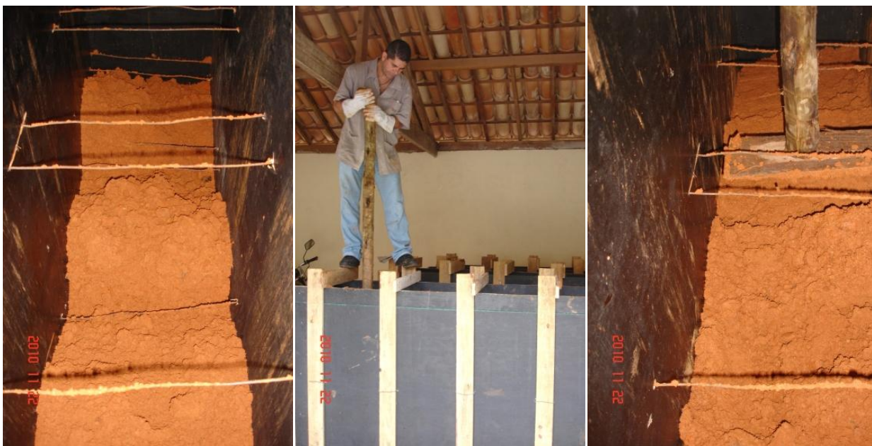
FIGURAS 30, 31 e 32 – Compactação do painel 1 – Painel defeituoso
