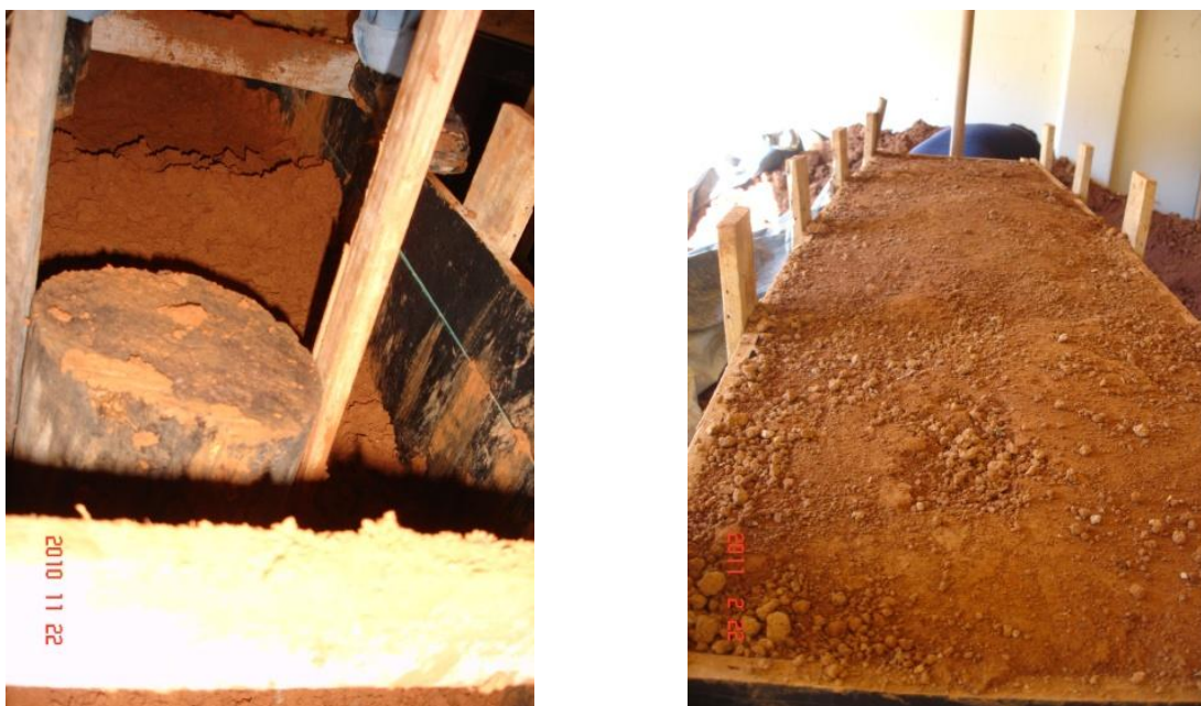
FIGURAS 33 e 34 – Compactação do painel 1 – Painel defeituoso
