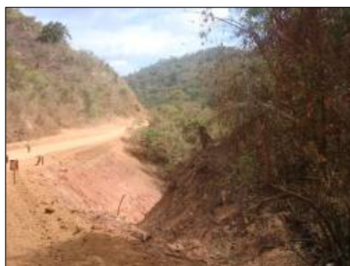
Figura 56 – Talude de aterro sem vegetação Fonte: CARDOSO, 2007
