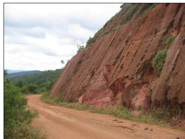
Figura 37 – Erosões no talude de corte Fonte: ENECON, 2007
