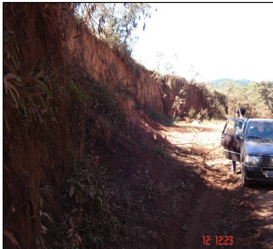
Figura 29 - Escorregamento em talude de corte Fonte: ENECON, 2007
