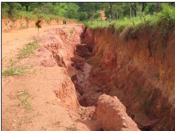
Figura 38 – Erosões no bordo da pista Fonte: ENECON, 2007
