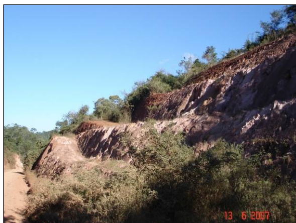
Figura 41 – Instabilidade no talude de corte Fonte: ENECON, 2007
