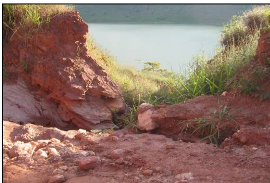
Figura 32 – Escorregamentos e erosões no trecho São José da Safira – Entr.º BR-451 (Nacip Raydan) Fonte: ENECON, 2007
