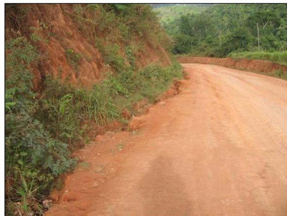
Figura 39 – Erosões no talude e bordo da pista Fonte: ENECON, 2007
