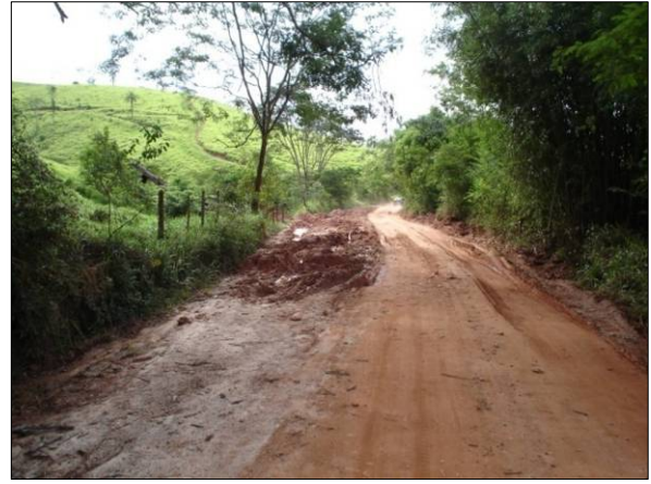
Figura 26 - Trecho Dom Joaquim – Entr. MG-010 sem pavimento Fonte: ENECON, 2007
