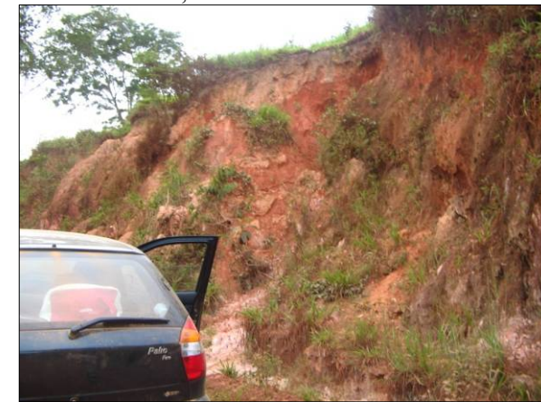
Figura 28 - Erosões no talude de corte Fonte: ENECON, 2007
