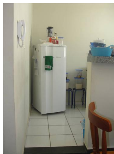
FIGURA 45 – Residencial Juatuba – Cozinha sem revestimento nas paredes.
