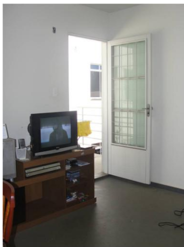
FIGURA 44 – Residencial Juatuba – Sala sem revestimento no piso
