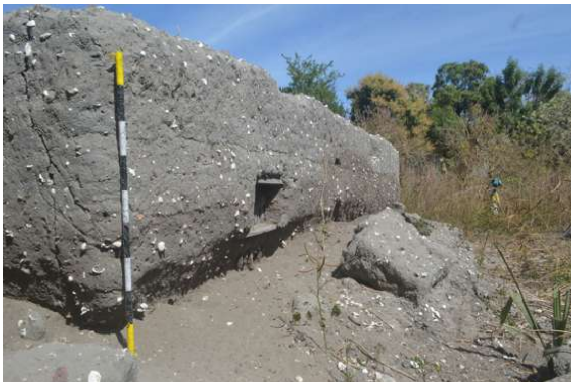
Fig. 224 - Bulhab 50 - Bulol - Conchas evidentes na parede em dissolução. Fotografia: autor.
