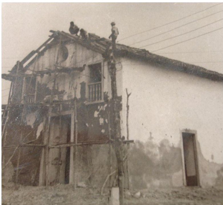
Figura 30 – Capela de Nossa Senhora do Rosário dos Homens Pretos, Chapada do Norte, século XVIII. A foto acima mostra uma reforma emergencial realizada na década de 70. Fonte: IEPHA, década de 70.
