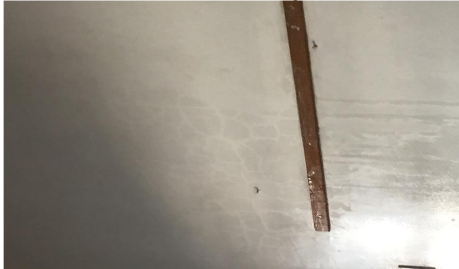
Foto 10 – Parede sob águas
