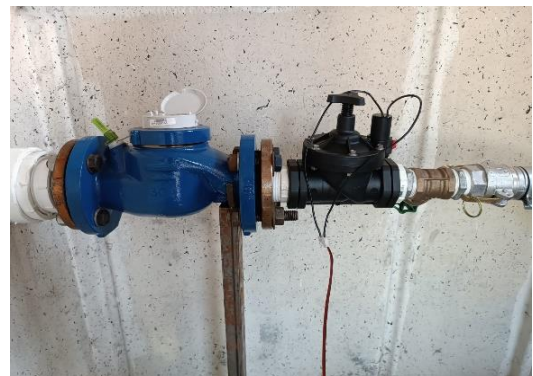
(c) Válvula de manobra a jusante e hidrômetro (Detalhe B)
