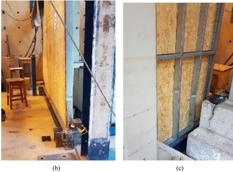
(b) (c) Figura 3.16 Modelo M2C: a) montagem antes do ensaio; b) modelo após ensaio, no momento da falha da placa OSB e do montante oposto ao da aplicação da força lateral; c) modelo após ensaio mostrando o painel flambado lateralmente, incluindo os três montantes mais próximos da aplicação da força lateral. (DE FARIA, 2023)
