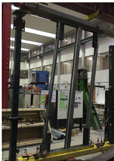
a) Painel de aço puro
