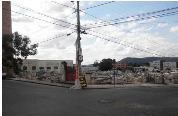
Figura 78: Local de implantação do edifício da tinturaria e depósito de algodão da Unidade I, após ter sido destruído. Foto: Mariana Gonçalves Moreira. Junho de 2014
