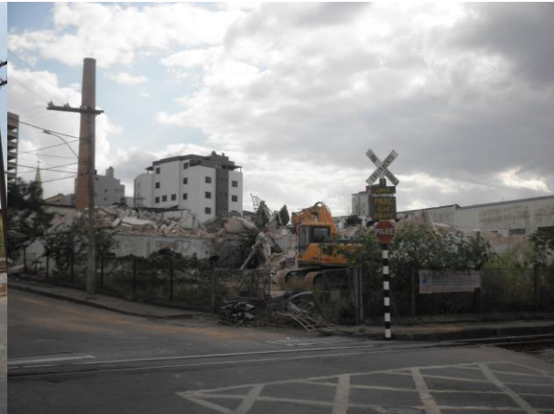
Figura 80: Local de implantação do edifício da tinturaria e depósito de algodão da Unidade I, após ter sido destruído. Foto: Mariana Gonçalves Moreira. Junho de 2014
