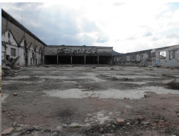
Figura 53: Fachada do setor de tecelagem da Unidade I da Companhia Industrial Itaunense. Área interna destruída. Foto: Mariana Gonçalves Moreira. Junho de 2014.
