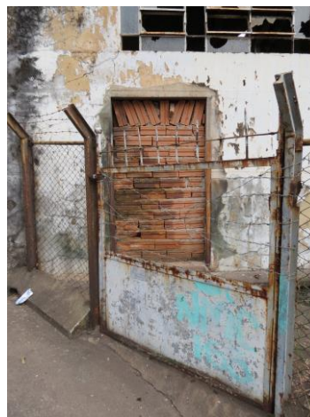
Figura 57: Fachada da Unidade I da Companhia Industrial Itaunense. Verifica-se entrada vedada por tijolos sem revestimento. Portão e cerca em processo de oxidação. Foto: Mariana Gonçalves Moreira. Janeiro de 2013.
