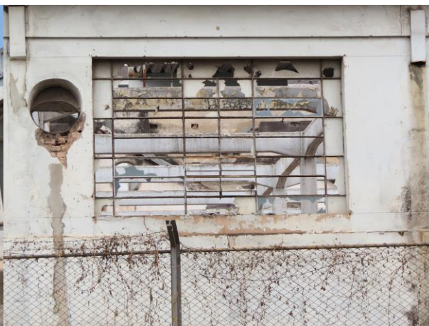
Figura 55: Fachada da Unidade I da Companhia Industrial Itaunense. Detalhe de vidros das janelas quebrados, descolamento de parte da pintura e reboco, presença de sujidades. Foto: Mariana Gonçalves Moreira. Janeiro de 2013.
