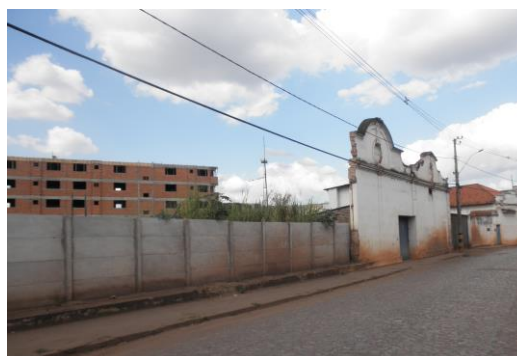
Figura 74: Fachada do edifício de atividades de suporte à tecelagem parcialmente destruída. Foto: Mariana Gonçalves Moreira. Junho de 2014
