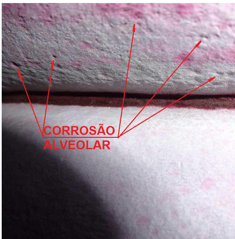
Figura 4. 18 – Foto da superfície interna do duto inspecionado, apresentando em maior detalhe a corrosão localizada (Fonte: Imagens cedidas pela empresa SMS group).
