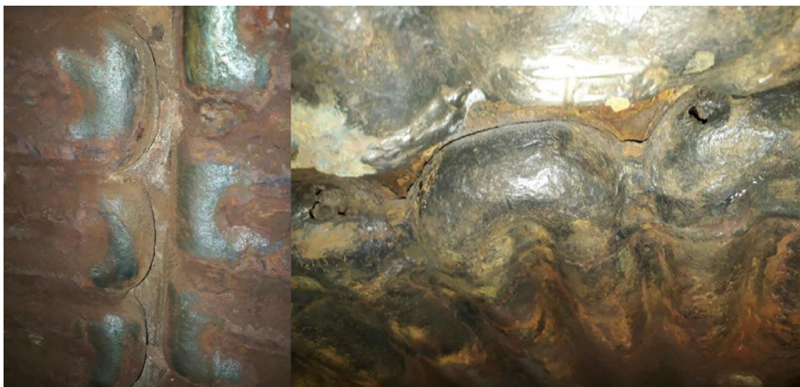
Figura 4. 19 – Foto da superfície interna do duto inspecionado, apresentando a região dos caps com corrosão severa (Fonte: Imagens cedidas pela empresa SMS group).
