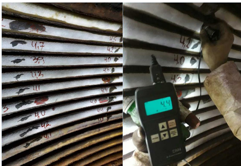
Figura 4. 20 – Foto da superfície interna do duto durante a medição de espessura, mostrando valores encontrados de espessura em cada ponto (Fonte: Imagens cedidas pela empresa SMS group).
