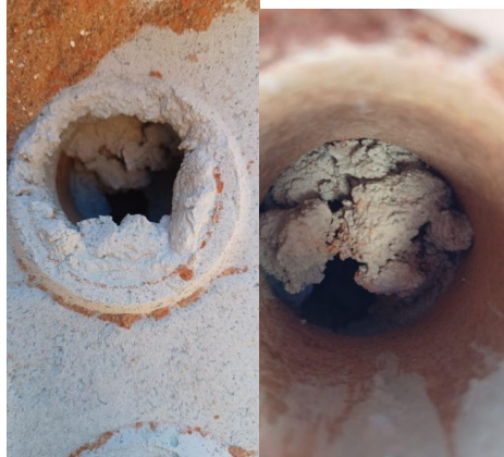
Figura 3.8 – Acúmulo de argamassa nos furos verticais das pequenas paredes.
