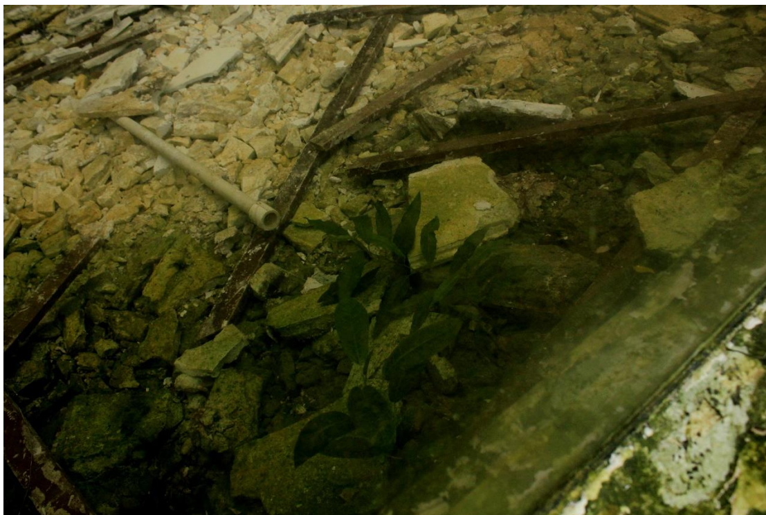
Figura 112. Detalhe interior de New House , de Lygia Pape no Museu do Açude em 22 de janeiro de 2018 com presença de vegetação e canos soltos
