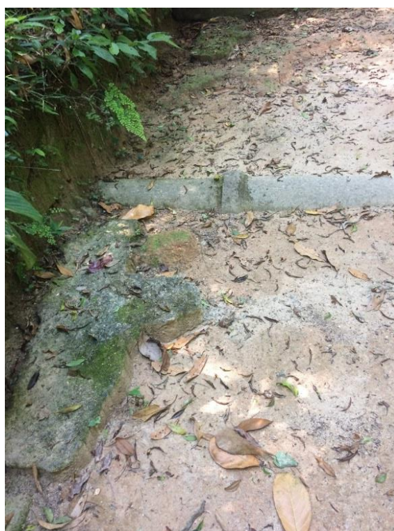
Figura 139. Detalhe de cano de concreto exposto na via do Museu do Açude em que as instalações de Nuno Ramos estão alocadas
