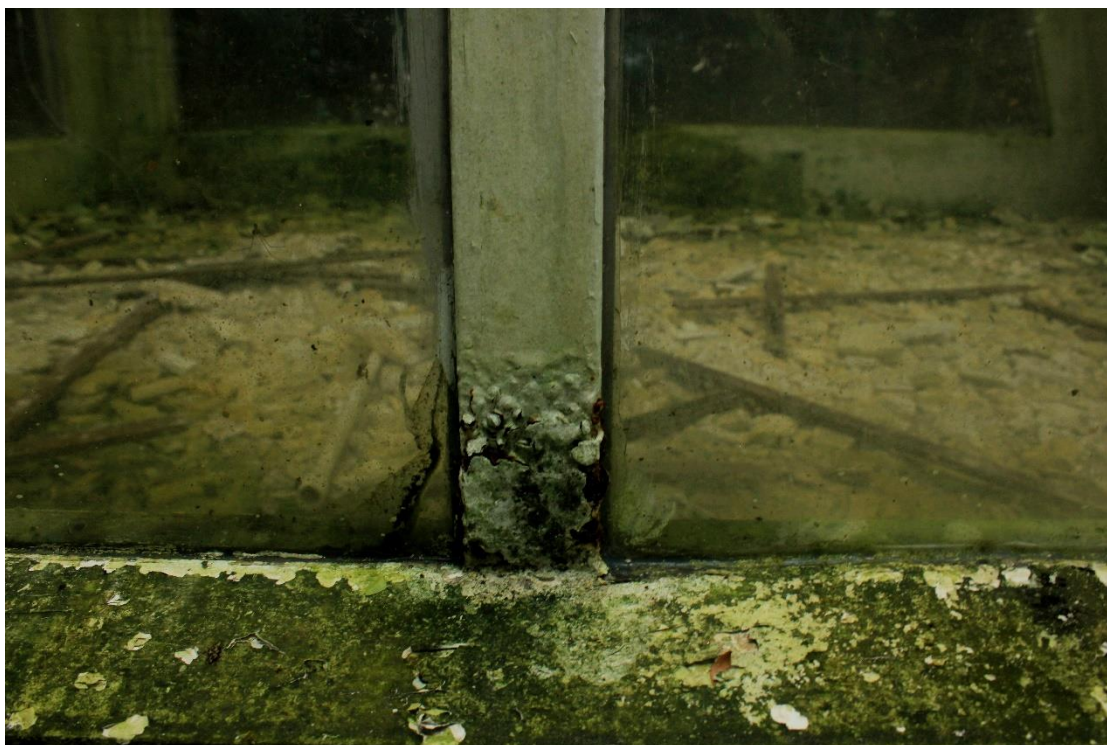
Figura 113. Detalhe de ferragem junto aos vidros com oxidação ativa em New House , de Lygia Pape no Museu do Açude em 22 de janeiro de 2018
