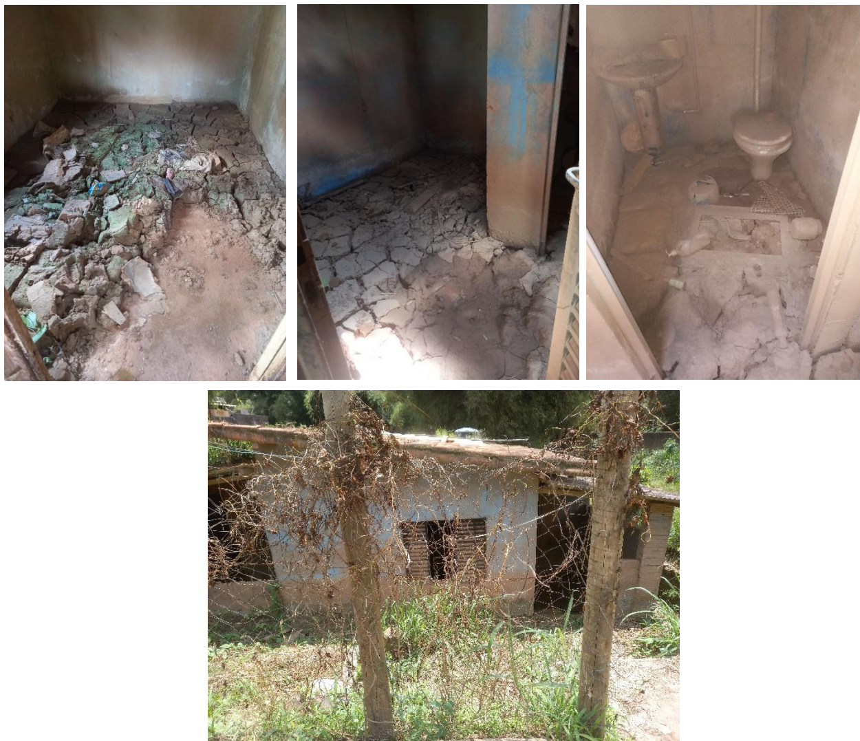
Figura 37: Residência na Comunidade Ribeirinha Amianto coberta por lama das cheias do rio Paraopeba de 2022
