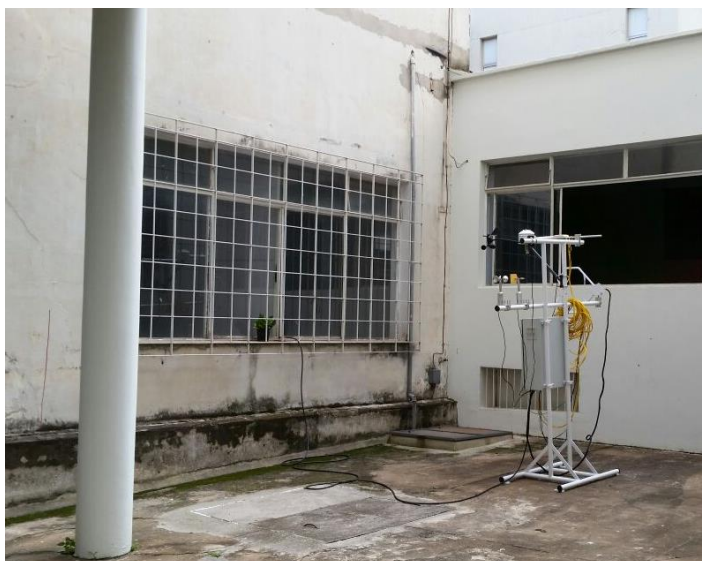
Figura 56- Abrigo do CR3000 Microllogger
