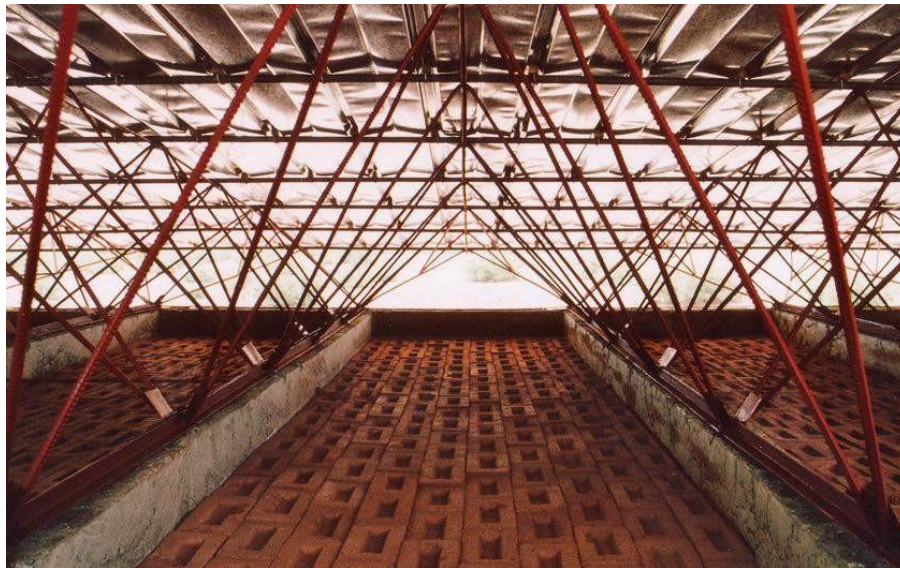
Imagem 16: Espaçamento entre os tetos e a telha metálica, que auxilia na refrigeração interna.
