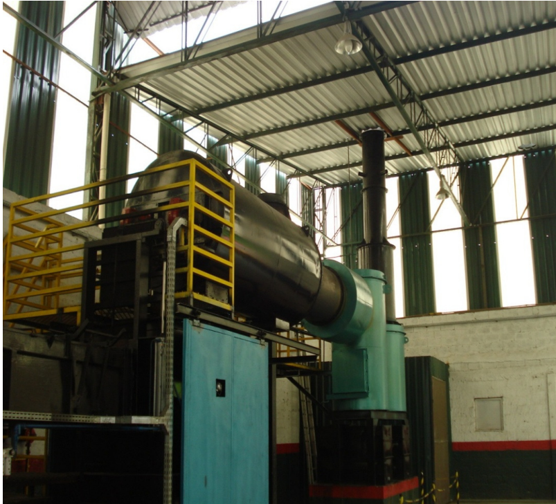
Figura 3- Incinerador da Empresa SERQUIP
