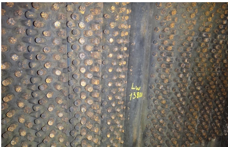
Figura 3-9 - Tubos pinados da fornalha de uma caldeira de recuperação química (ISQ BRASIL, 2014).
