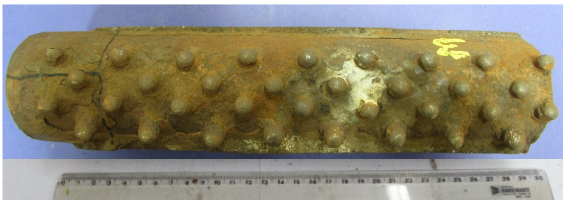
Figura 4-3 - Amostra 2: tubo usado com pinos que estava em operação na caldeira sem a reposição de espessura.
