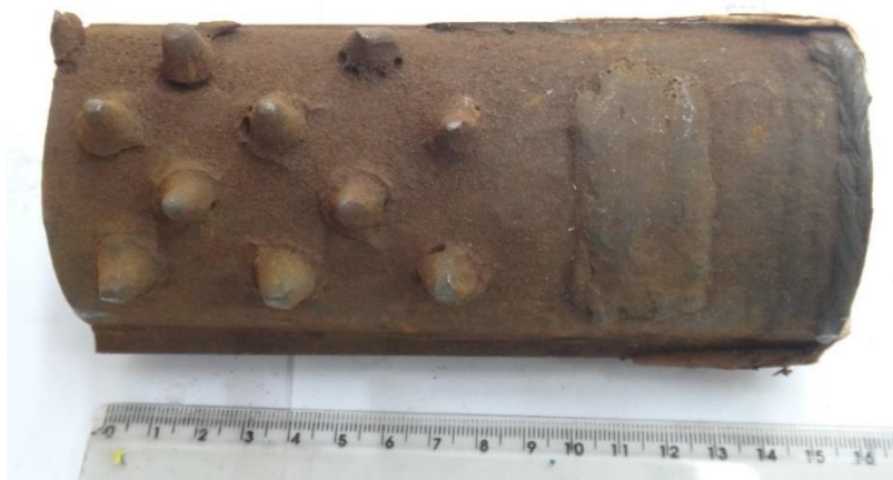
Figura 4-6 - Amostra 5: tubo usado da caldeira de recuperação com pinos onde foi feita a reposição da espessura por soldagem dentro da caldeira e que continuou em operação durante mais 1 ano.
