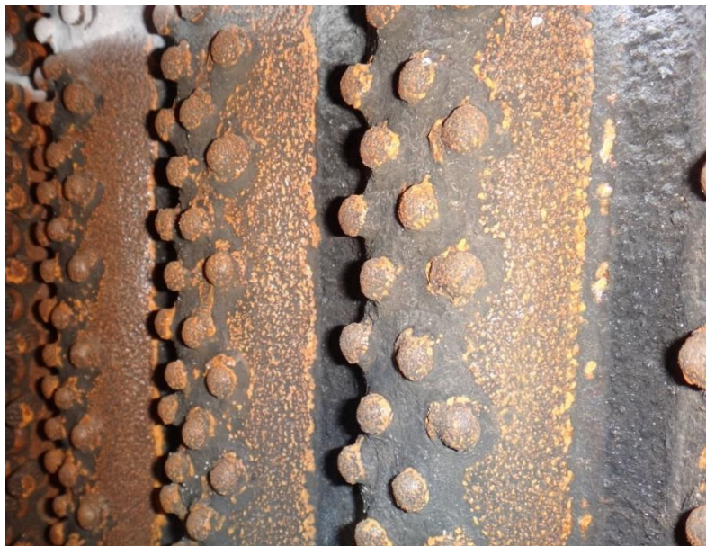
Figura 3-11 - Pinos corroídos (ISQ BRASIL, 2014).
