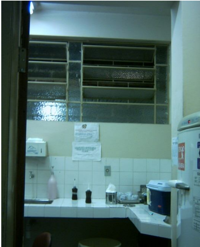
Foto 14 – Detalhe da sala de imunização. Da metade inferior da janela para baixo é possível avistar a iluminação da Copa e na metade superior o telhado em telhas onduladas de fibro cimento.
