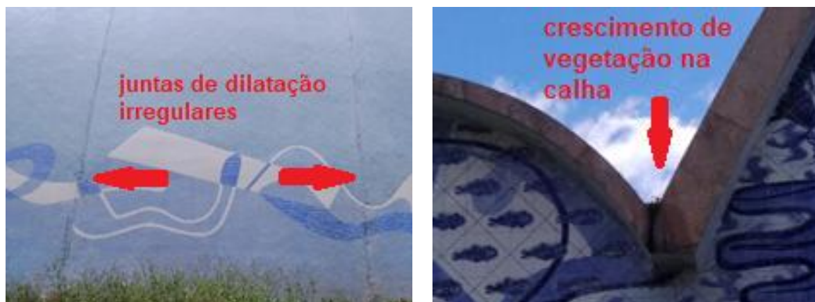
Figura 41 – Patologias visíveis a olho nu em 02/03/2021
