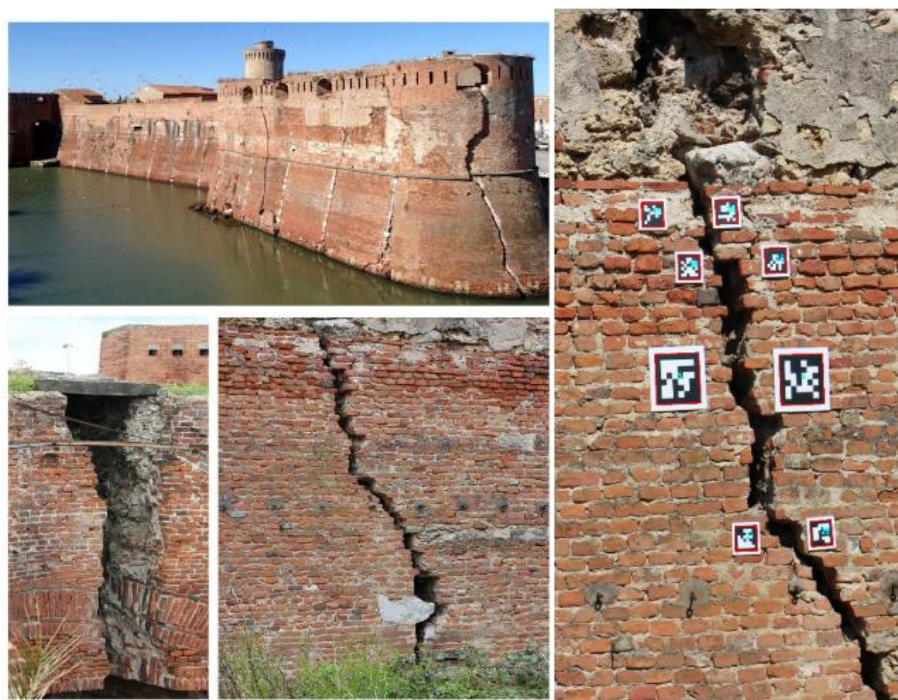
Figura 15 – Monitoramento de rachadura na Fortezza Vecchia em Livorno (Itália) com utilização de marcadores
