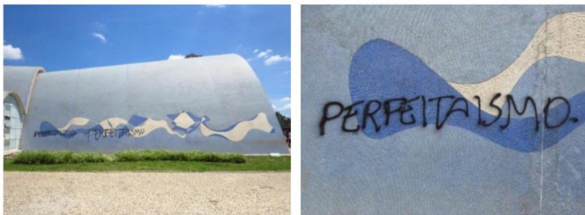
Figura 40 – Pichação na lateral esquerda da nave.
