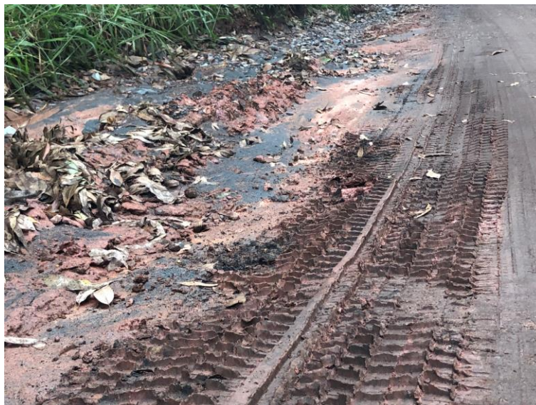
Figura 5.33 - Ocorrência do defeito estrutural segregação de agregados em grande frequência no acostamento das estradas não revestidas.
