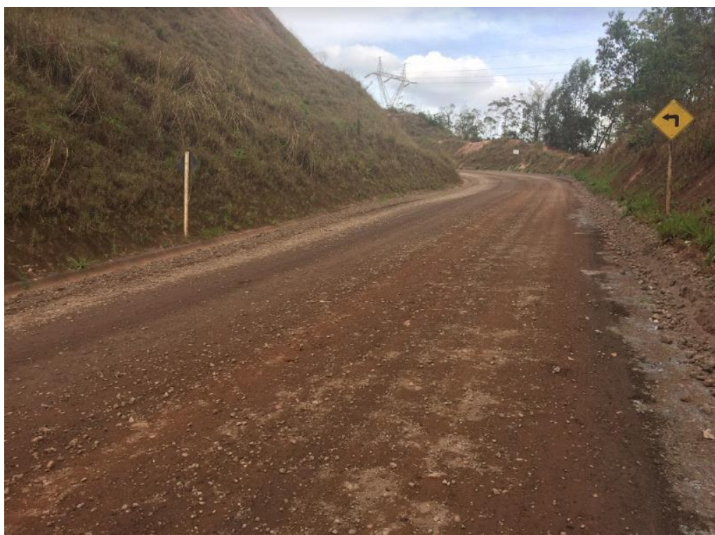
Figura 4.6 - Aplicação do revestimento finalizada e estrada liberada para o trânsito de veículos.
