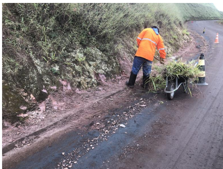
Figura 5.39 - Realização da limpeza de canaletas de escoamento de águas pluviais após período de chuvas: a manutenção garante maior longevidade do revestimento construído.
