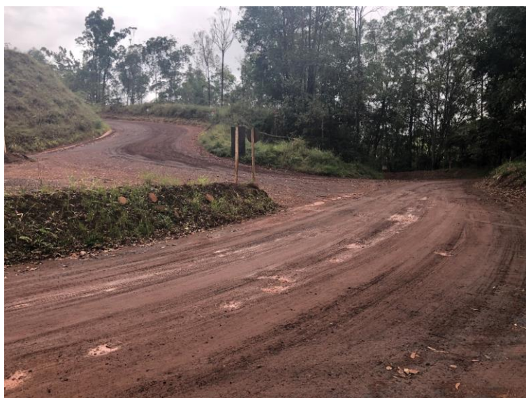
Figura 5.17 - Interseção entre estrada experimental com o revestimento construído (à esquerda) e estrada não revestida (abaixo), após ocorrência de precipitação.
