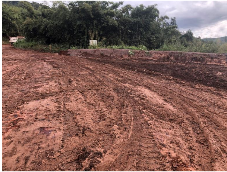
Figura 5.28 - Estrada não revestida com formação de trilhas de rodas com alta severidade em toda a sua extensão.
