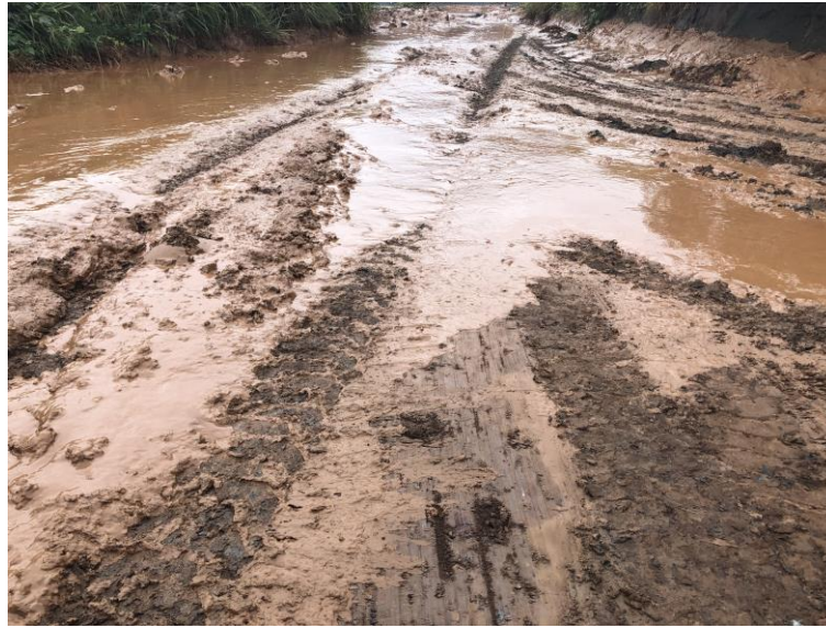
Figura 5.19 - Trecho de uma das pistas não revestidas com impossibilidade de verificação apurada do defeito estrutural corrugação devido à lama formada na superfície.
