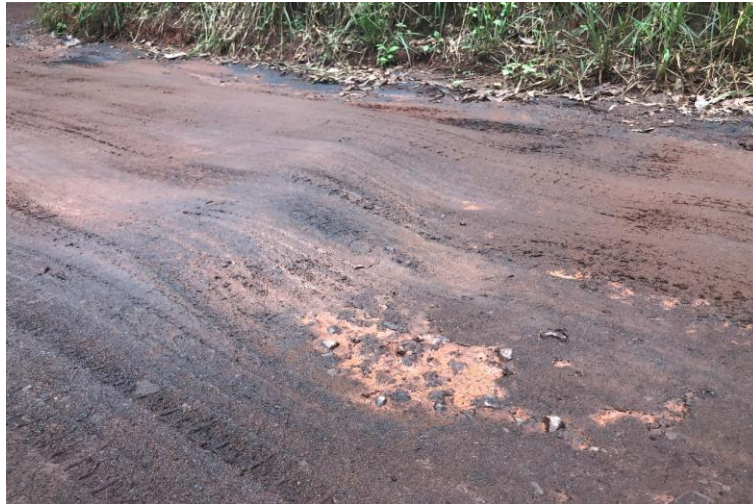
Figura 5.21 - Evidência de dos defeitos estruturais qualitativos corrugações de média intensidade em estrada não revestida.
