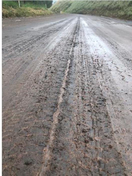
Figura 5.31 - Marcas de rodas no revestimento construído, não caracterizadas como trilhas de rodas.
