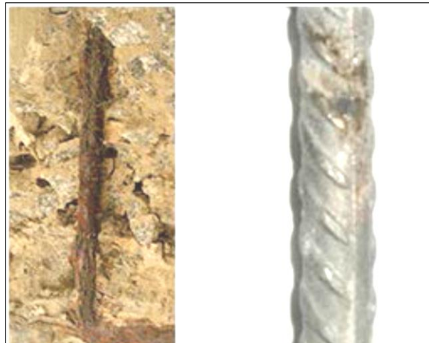
Figura 2.1 - Corrosão generalizada (esquerda) e corrosão por pites ou puntiforme (direita) no aço Fonte: MEIRA, 2017, p. 20.
