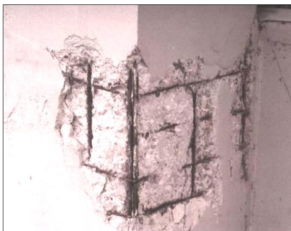
Figura 2.5 - Corrosão de armadura induzida por cloretos Fonte: VAGHETTI et al. , 2002 apud SCHNEIDER, 2005.
