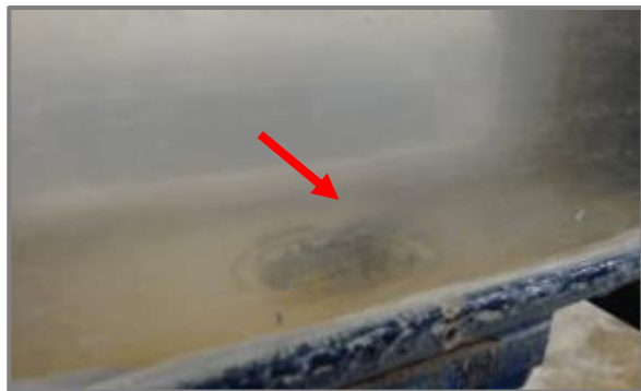
c-) Observa-se desprendimento de material em camada exposta de aproximadamente 1 mm.
