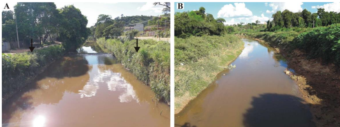
Figura 5.13 – Dois leitos de um rio: em A o leito canalizado do Rio Todos os Santos, cujos gabiões estão cobertos por vegetação que invade o canal, demarcados com as setas, em contraste com o trecho a jusante, em que inexistem as intervenções por meio de gabiões – B.
