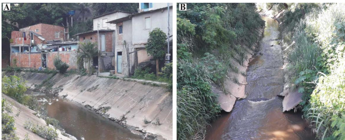
Figura 5.9 – Aspectos do setor canalizado do Rio Santo Antônio em Teófilo Otoni. Em A se verifica a proximidade entre as residências e o canal e, em B, o estágio degradado da intervenção de natureza estrutural junto à calha fluvial.
