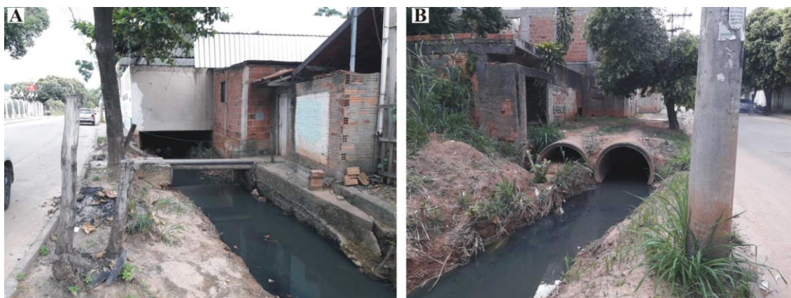
Figura 5.19 – Aspecto do leito do Rio São Jacinto. Note as passarelas rudimentares de madeira que ligam a rua às residências ou a casa construída sobre o canal (A) e a canalização precária, parcialmente entulhada por sedimentos e lixo (B).
