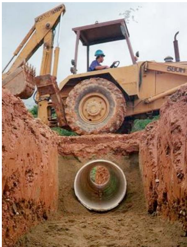
FIGURA 32 – Corte exemplificando o assentamento correto dos tubos Rib Loc Fonte: Manual Técnico da empresa Aqueduto, 2014
