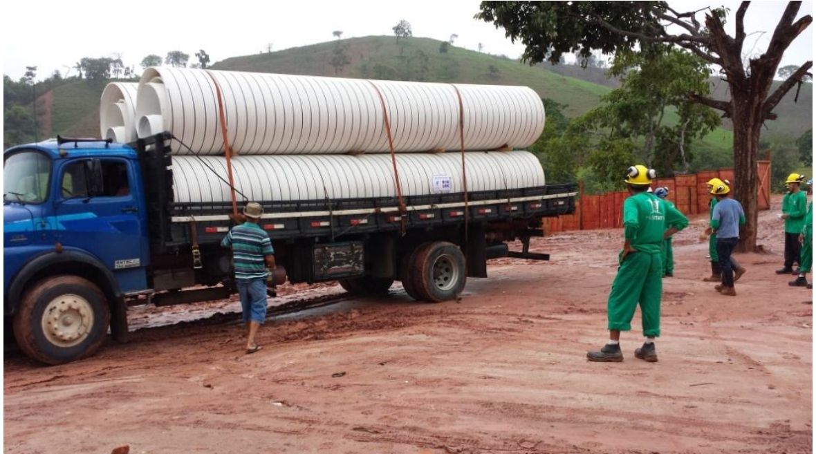
FIGURA 35 – Chegada da primeira carga de tubos Rib Loc à obra Fonte: Arquivo próprio, 2015
