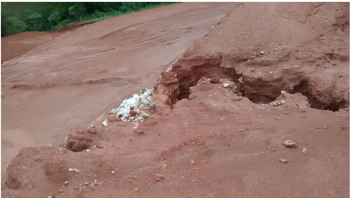
FIGURA 29 – Situação taludes e rua “A” após chuva Fonte: Arquivo próprio, 2014
