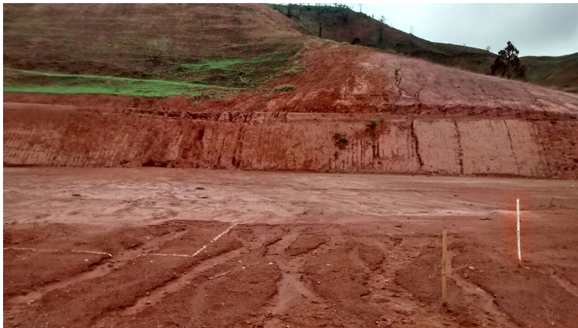
FIGURA 26 – Situação taludes e rua “A” após chuva Fonte: Arquivo próprio, 2014
