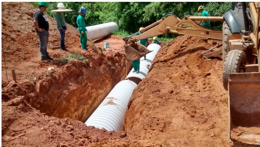
FIGURA 45 – Montagem dos tubos PVC Rib Loc com auxílio de retroescavadeira Fonte: Arquivo próprio, 2015
