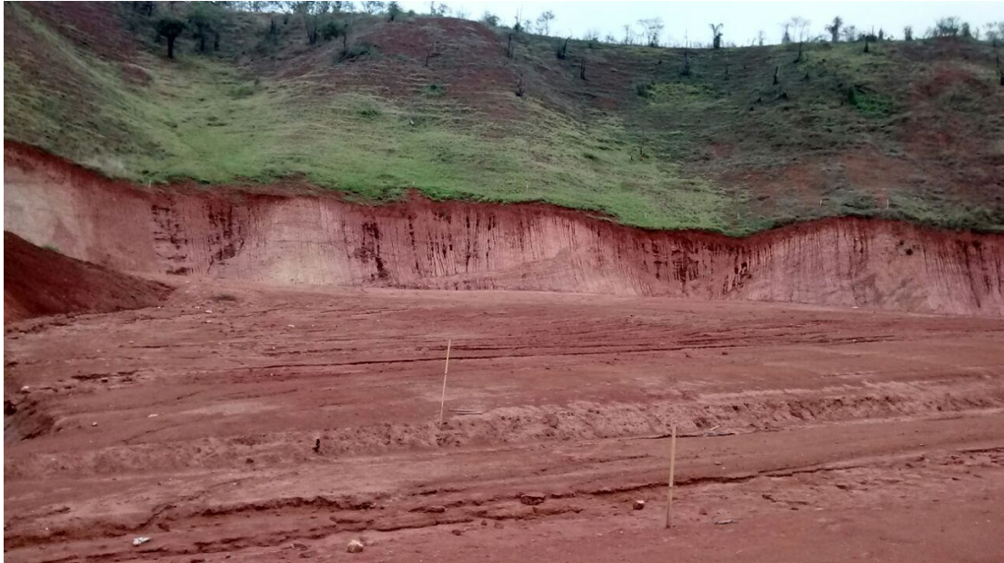
FIGURA 28 – Situação taludes e rua “C” após chuva Fonte: Arquivo próprio, 2014
