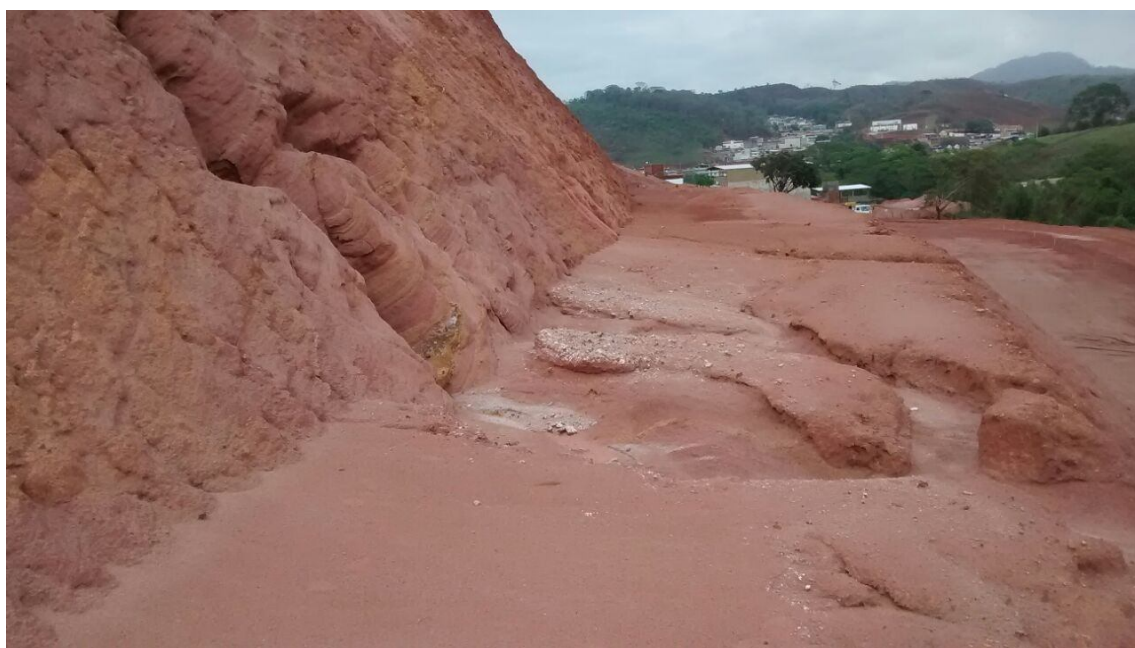
FIGURA 27 – Situação taludes e rua “A” após chuva Fonte: Arquivo próprio, 2014
