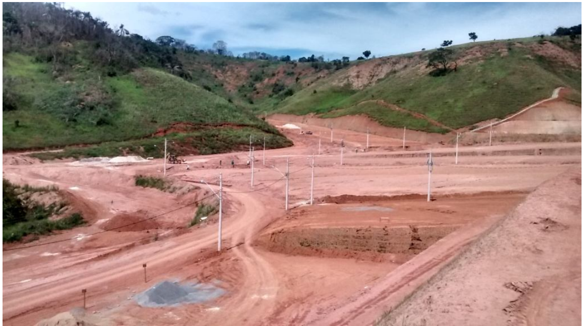
FIGURA 56 – Redes de drenagem profundas executadas e liberado o tráfego Fonte: Arquivo próprio, 2015
