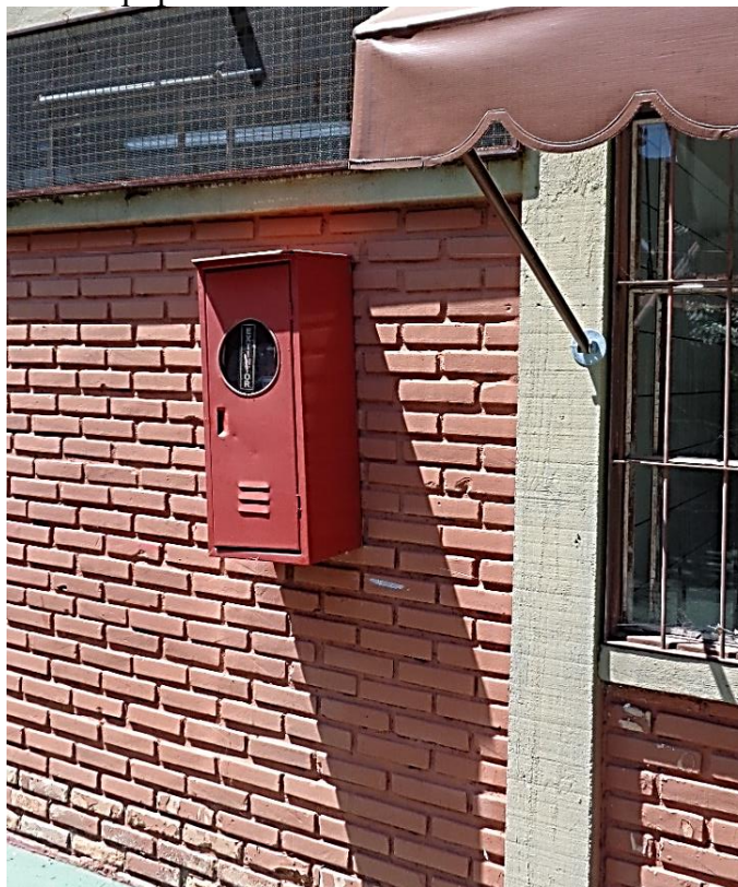
Figura 13 – Equipamento de combate a incêndio sem sinalização.
