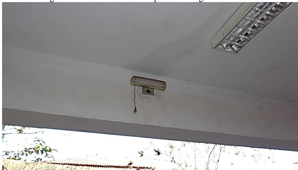
Figura 12 – Ponto de iluminação de emergência existente.
