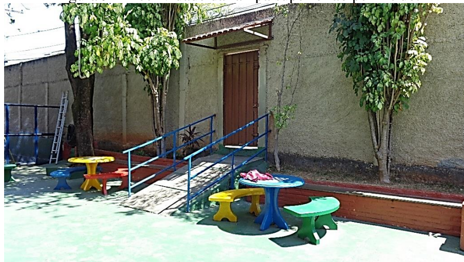
Figura 9 – Declividade da rampa superior ao permitido.
