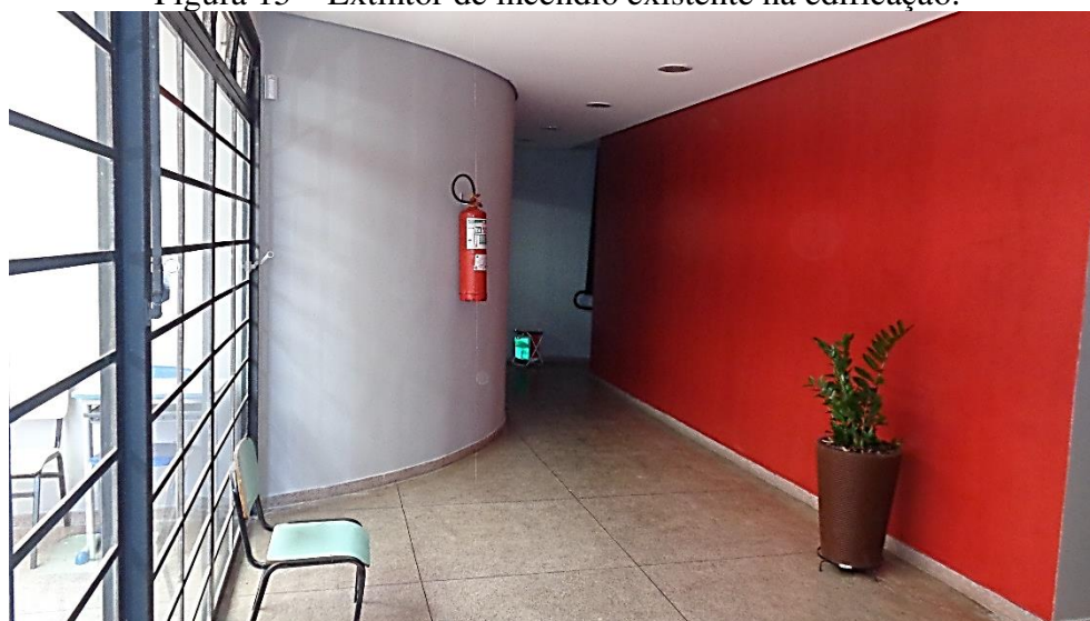
Figura 15 – Extintor de incêndio existente na edificação.
