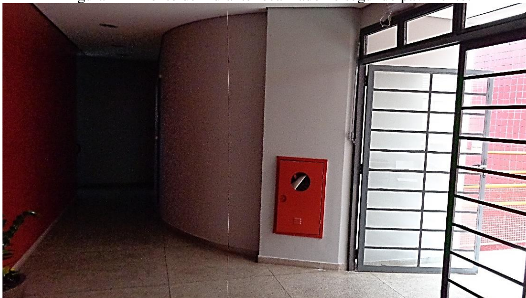
Figura 14 – Ponto de hidrante localizado no segundo pavimento.
