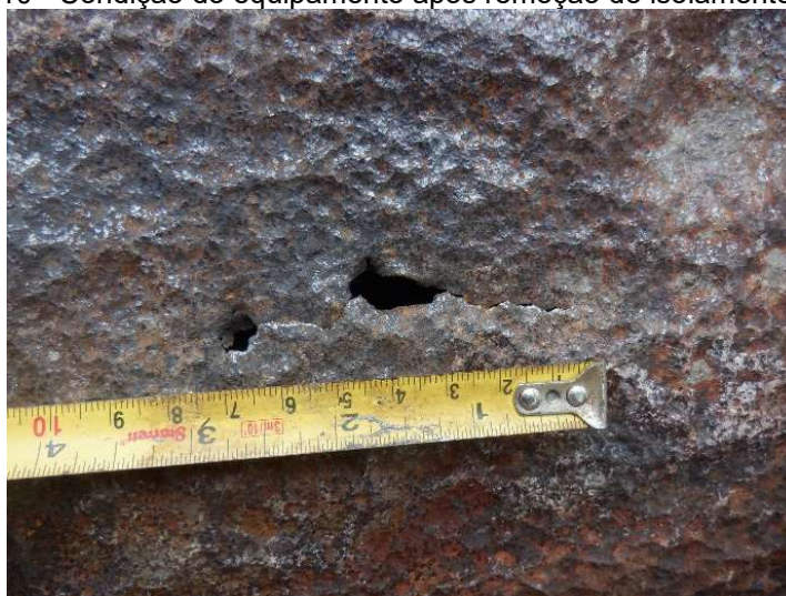
Figura 10 - Condição do equipamento após remoção do isolamento térmico
