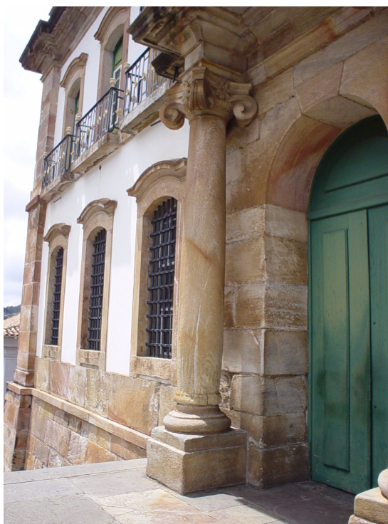
Figura III.8: Quartzitos amarelados a castanho avermelhados na fachada principal do Museu da Inconfidência, Ouro Preto.
