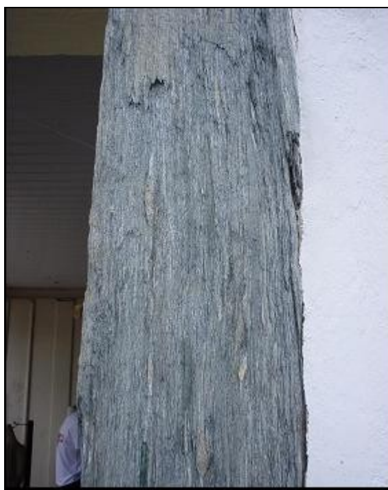
Figura III.14: Aspecto degradado em forma de desagregação e esfoliação em coluna edificada em xisto, Mariana.
