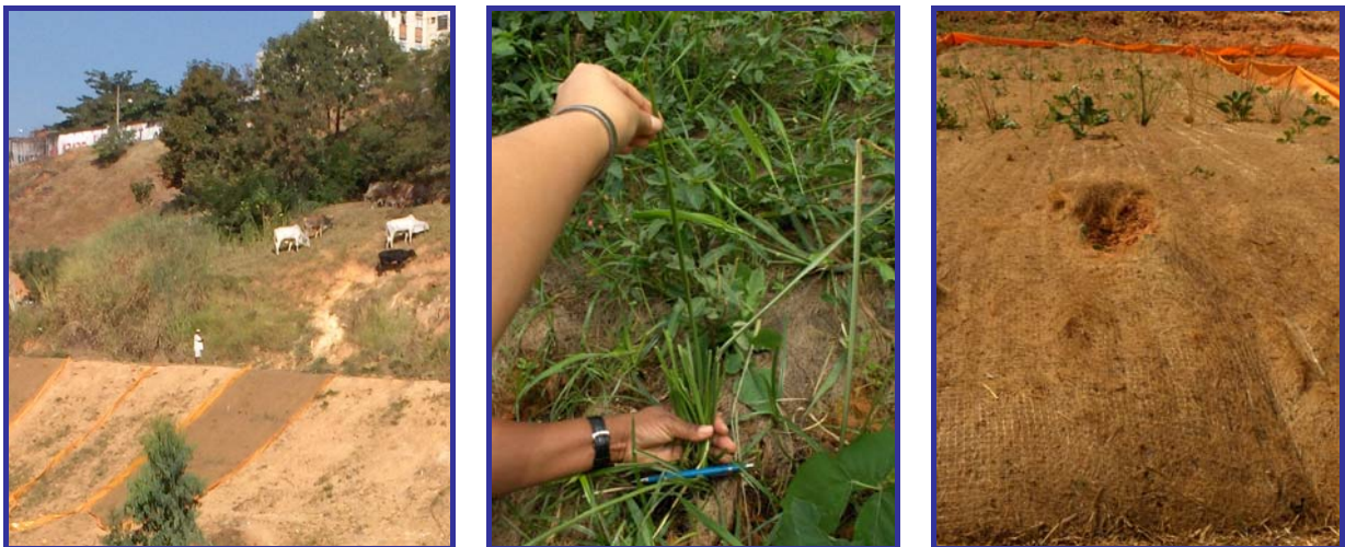
Figura 5.13 – Dificuldades na área da favela: (a) Presença de gado; (b) Capim destruído pela pastagem; (c) Efeito do pisoteio do gado
