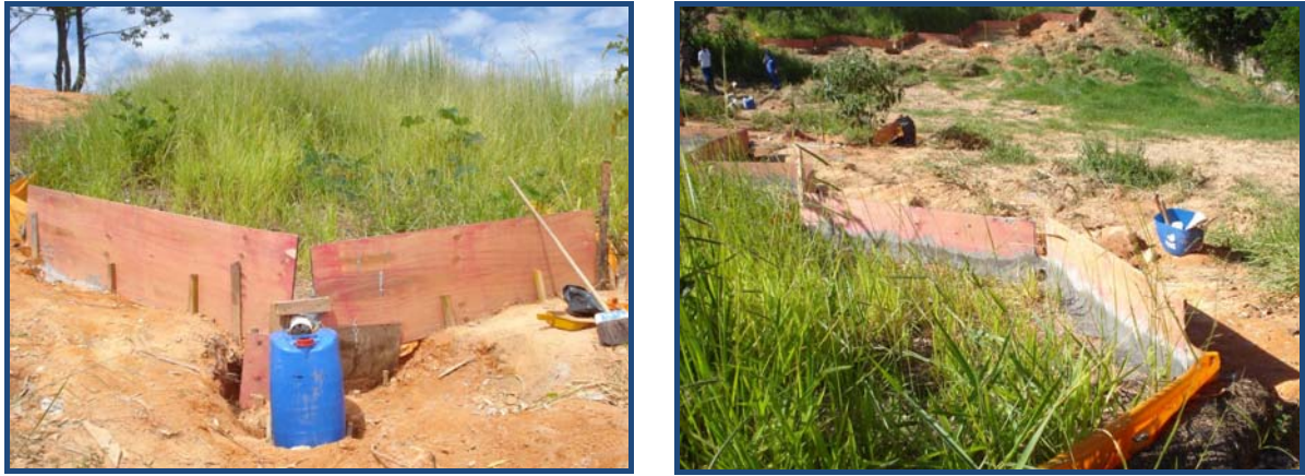
Figura 4.10 – Canalizadores de sedimentos: (a) Detalhe frontal; (b) Detalhe posterior
