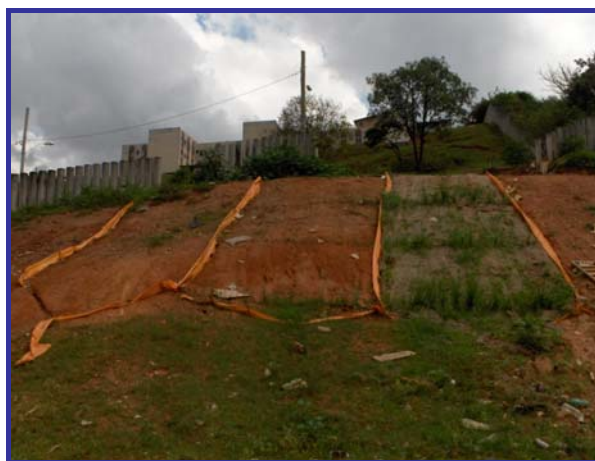
Figura 5.14 – Resíduos sólidos na área e deterioração das parcelas
