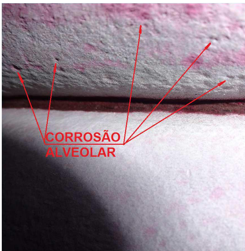
Figura 4. 18 – Foto da superfície interna do duto inspecionado, apresentando em maior detalhe a corrosão localizada (Fonte: Imagens cedidas pela empresa SMS group).
