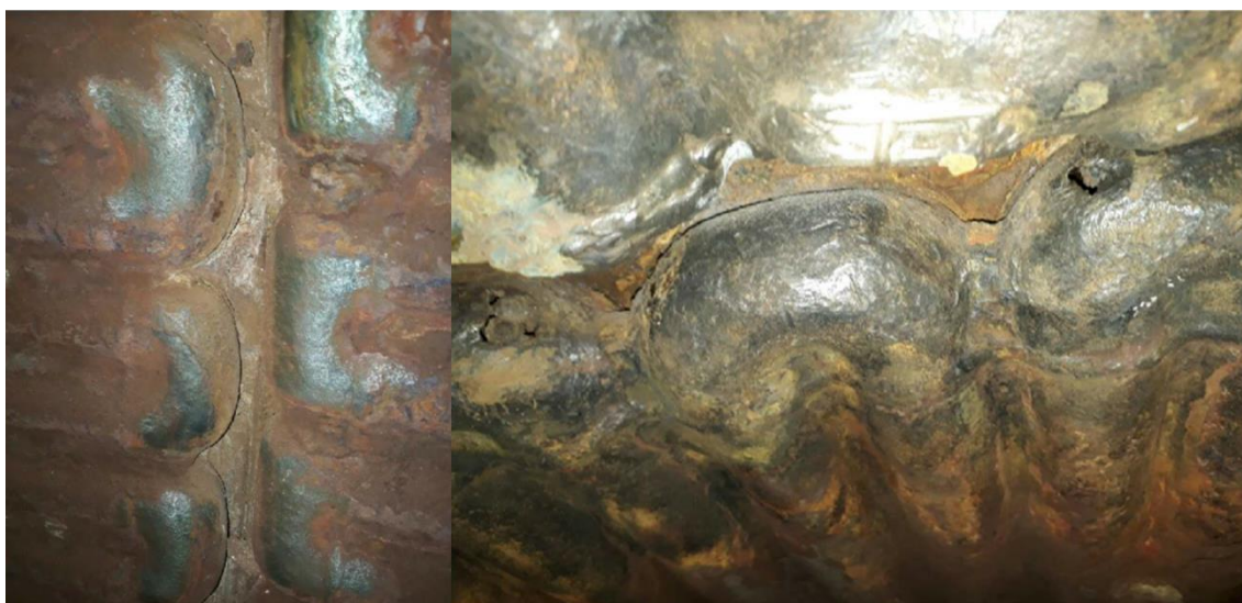
Figura 4. 19 – Foto da superfície interna do duto inspecionado, apresentando a região dos caps com corrosão severa (Fonte: Imagens cedidas pela empresa SMS group).
