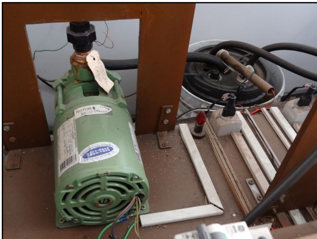
Figura 4.6 – Motobomba utilizada no sistema de aquecimento
