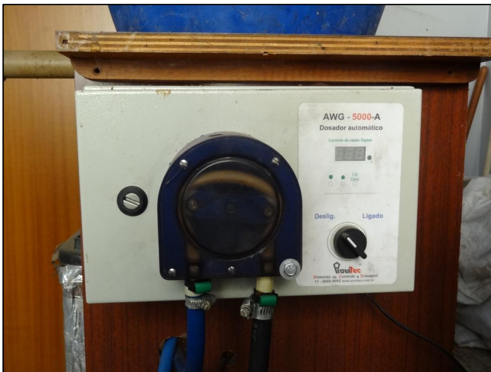
Figura 4.8 – Bomba peristáltica instalada no sistema (bomba 2)
