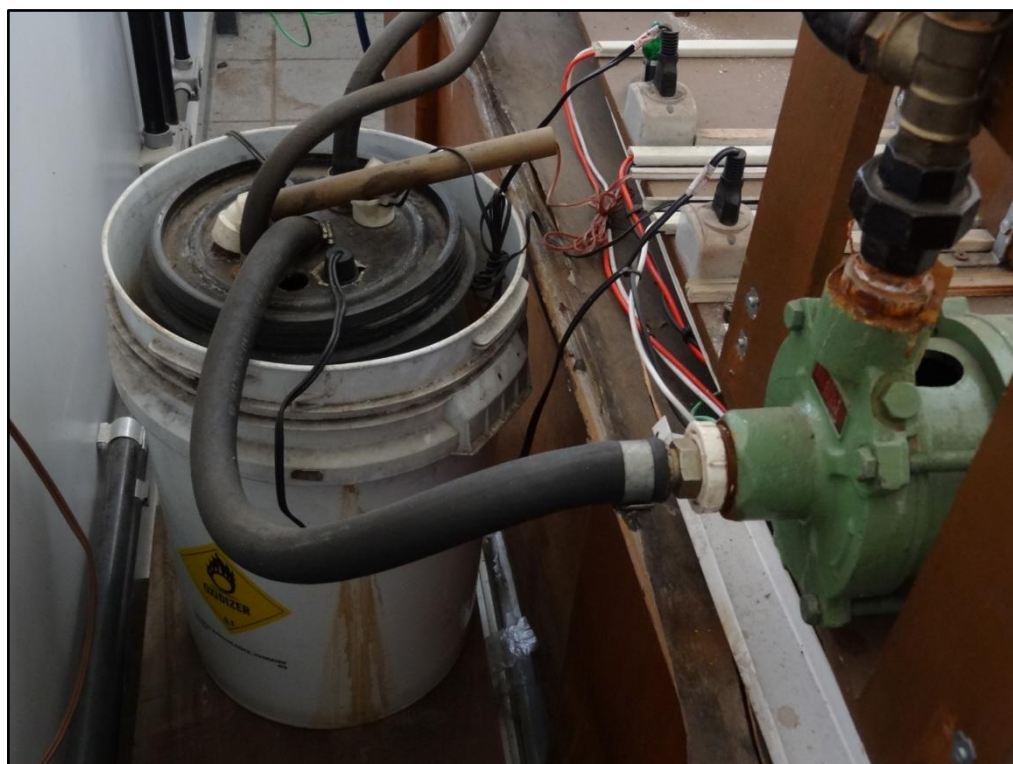
Figura 4.7 – Aspecto geral do sistema de aquecimento: Reservatório intermediário de 20 L e motobomba.
