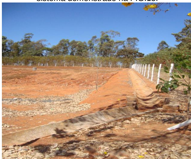
FIGURA 16: Vista do sistema de coleta do lixiviado na base do aterro e do sistema de drenagem pluvial do sistema demonstrado na FIG.15.
