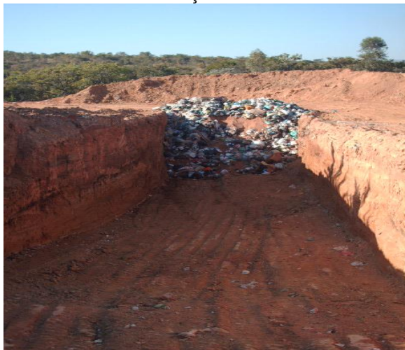
FIGURA 14: Vista de vala em utilização no aterro controlado do município “B”
