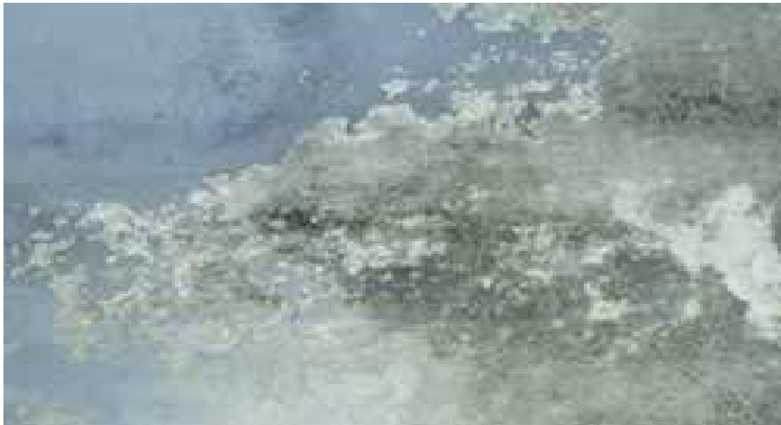
Figura 7 - Eflorescência Fonte, Polito, 2006
