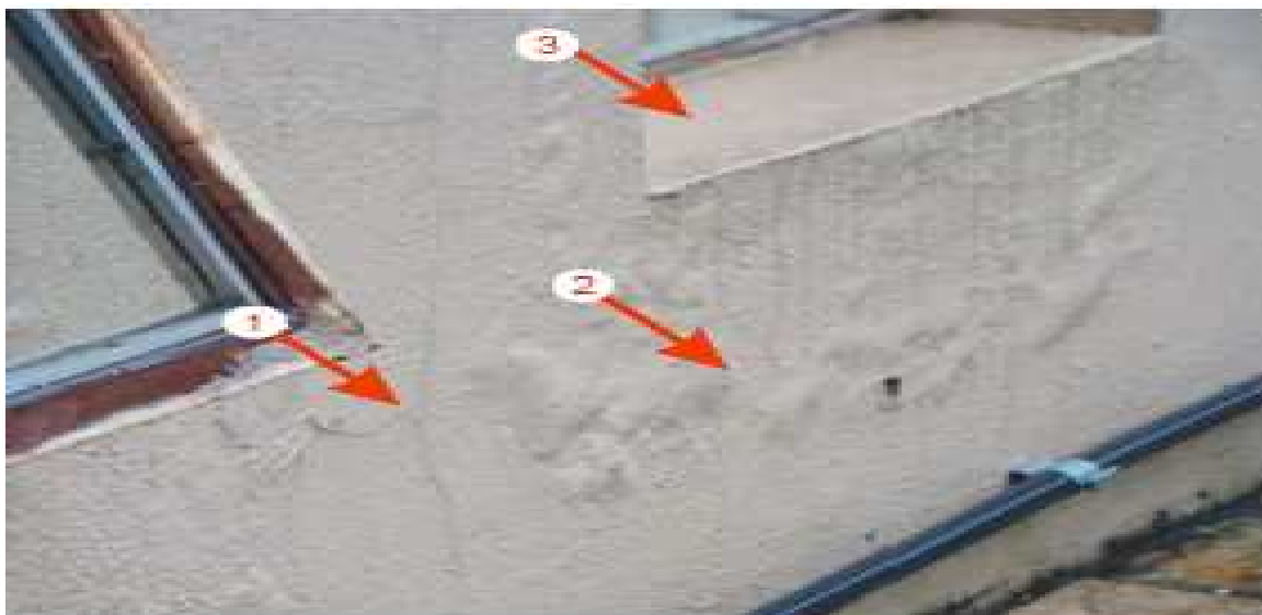
Figura 3 – Infiltração Fonte: Polito, 2010.
