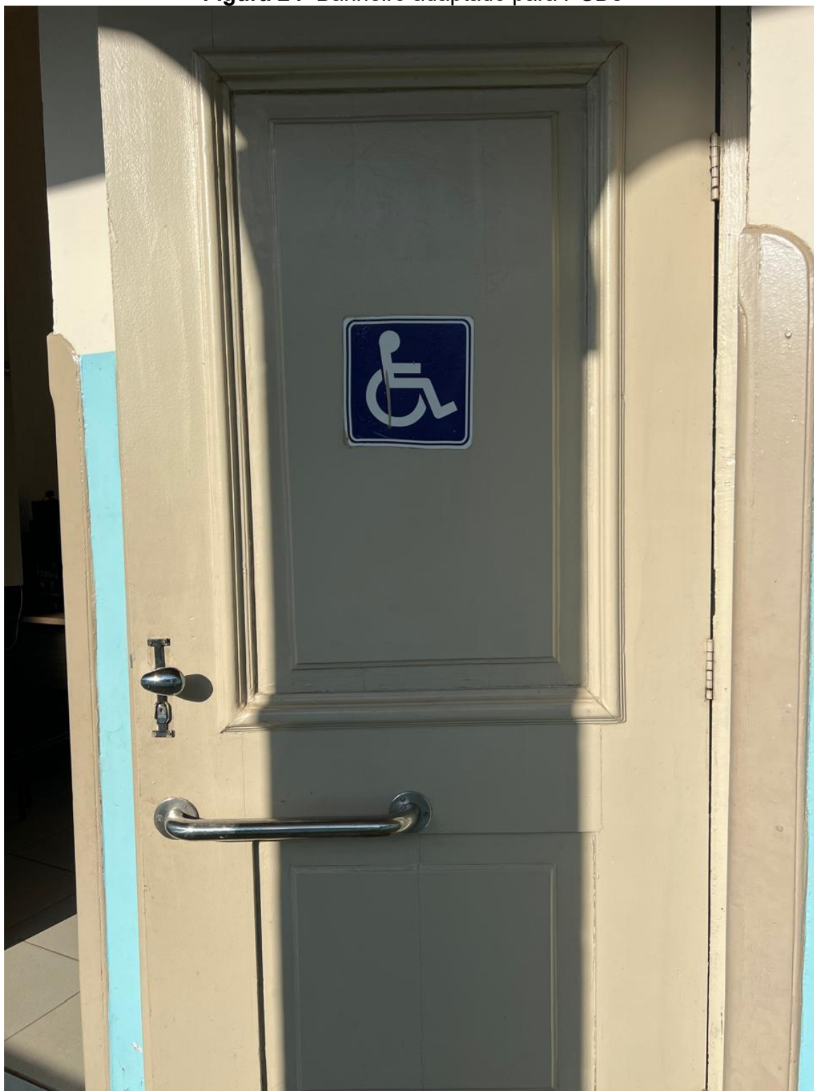
Figura 24- Banheiro adaptado para PCDs
