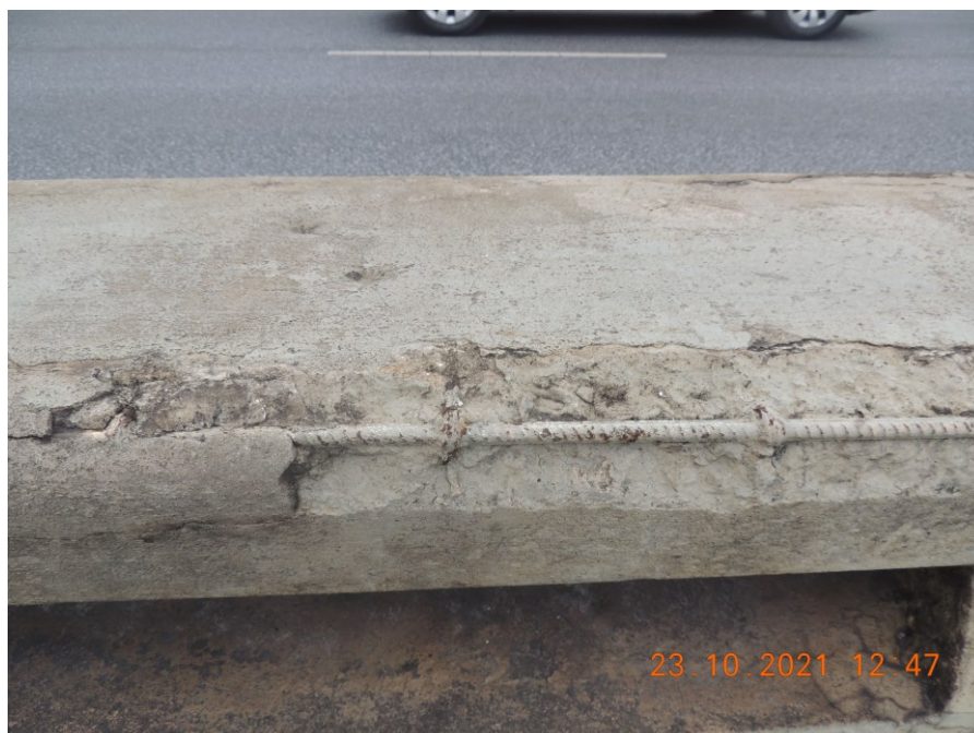
Figura 34. Pintura sobre armadura exposta na barreira rígida em concreto armado do viaduto Dona Helena Greco
