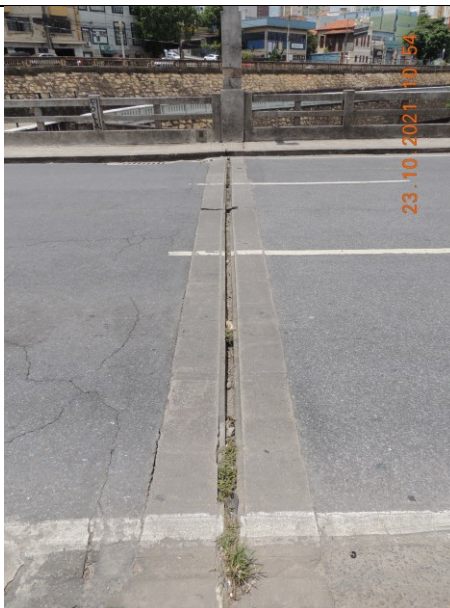
Figura 45. Crescimento de vegetação e falhas na vedação da junta de dilatação do viaduto Floresta em 2021
