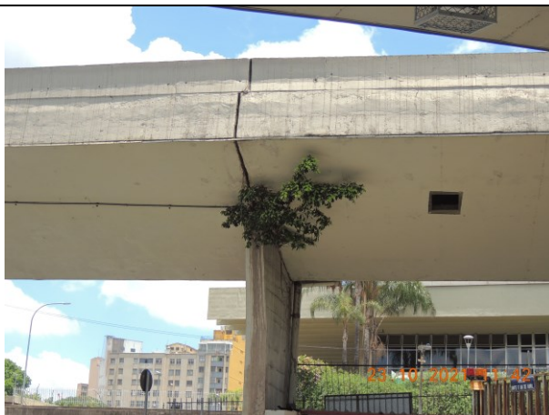
Figura 28. O crescimento de vegetação demonstra a presença/percolação de água na estrutura proveniente das falhas de vedação da junta de dilatação no viaduto Nansén Araújo
