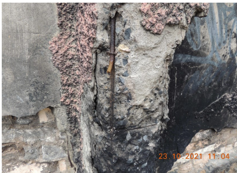
Figura 39. Barra de aço rompida devido à ação do fogo provocado por moradores de rua na base do pilar do viaduto Floresta
