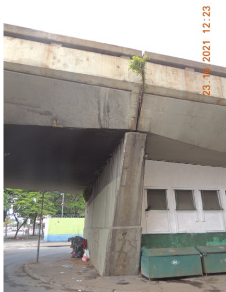
Figura 31. Crescimento de vegetação no interior da junta de dilatação devido a falhas na vedação do dispositivo permitindo a percolação de água no trecho
