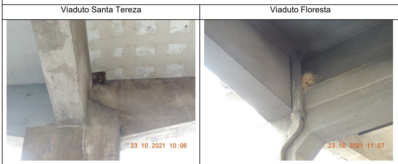
Figura 14. Ausência de continuidade nas tubulações ou falhas na ligação das tubulações do sistema de drenagem dos viadutos Santa Tereza e Floresta.
