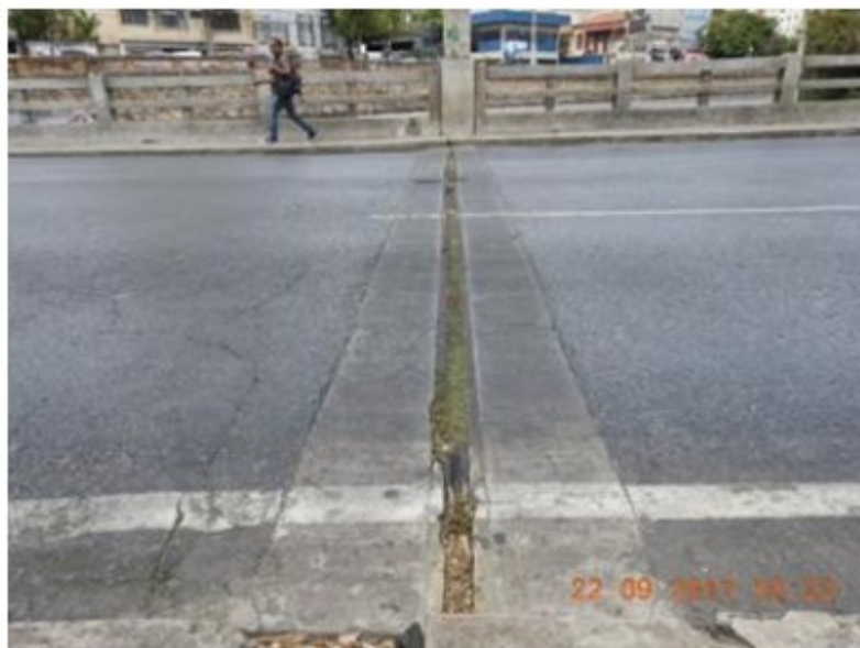
Figura 44. Crescimento de vegetação e falhas na vedação da junta de dilatação do viaduto Floresta em 2017
