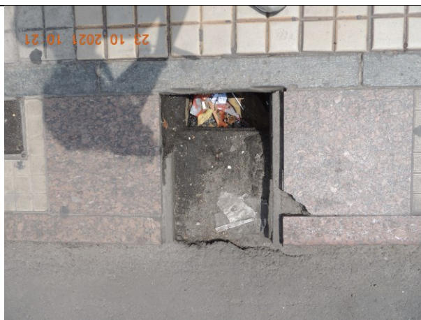
Figura 41. Ponto de captação de água do sistema de drenagem do viaduto Santa Tereza obstruídos com lixo no registro realizado em 2021
