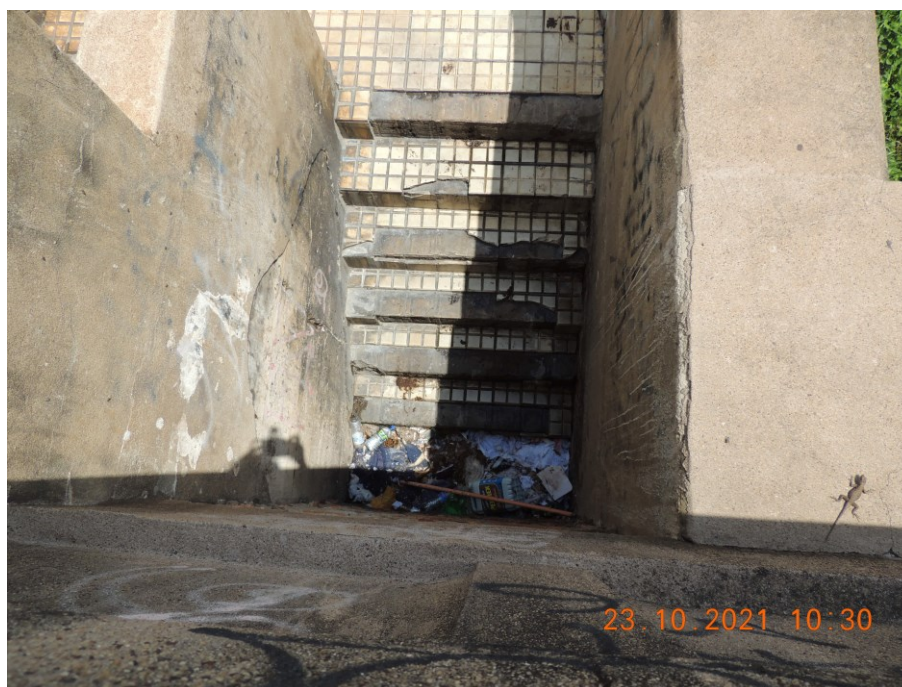
Figura 36. Uso inadequado da estrutura do viaduto Santa Tereza pelos usuários.
