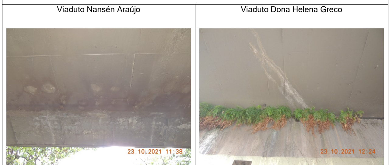
Figura 21. Manchas de eflorescências na região inferior do tabuleiro decorrente da percolação de água pela estrutura dos viadutos Nansén Araújo e Dona Helena Greco
