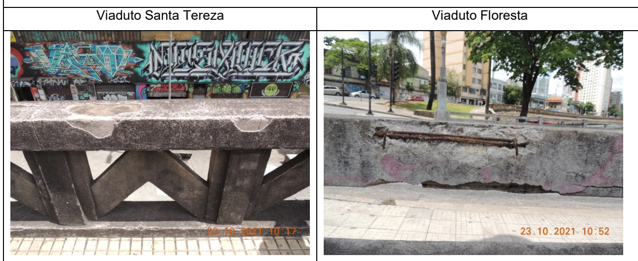
Figura 32. Trechos com deslocamento do concreto no viaduto Santa Tereza e exposição e corrosão das armaduras nas barreiras rígidas em concreto do viaduto Floresta
