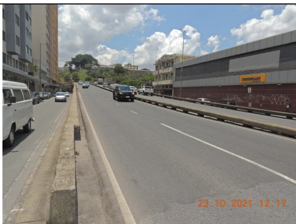
Figura 29. A inexistência de acesso para pedestres no trecho comprometeu a visualização da região superior do tabuleiro na região correspondente à junta de dilatação.
