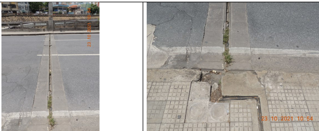
Figura 25. Falhas na vedação das juntas de dilatação favorecem a percolação de água pela estrutura e o crescimento de vegetação no viaduto Santa Tereza (vista superior)
