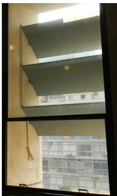
Figura 27 - Vista interna do sistema de acionamento dos brises – PGC, Rio de Janeiro - Foto: Acervo pessoal
