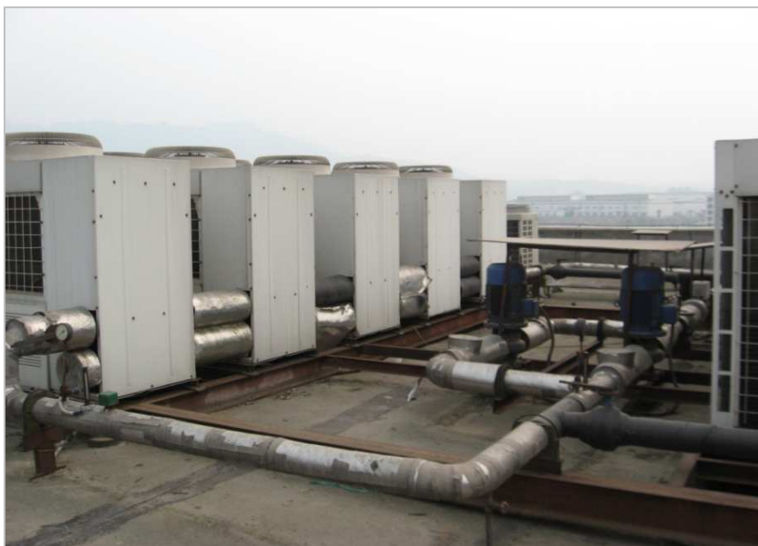
Figura 18 - Central de Água Gelada, com condensação a ar - Chongqing, China - Foto: Acervo próprio
