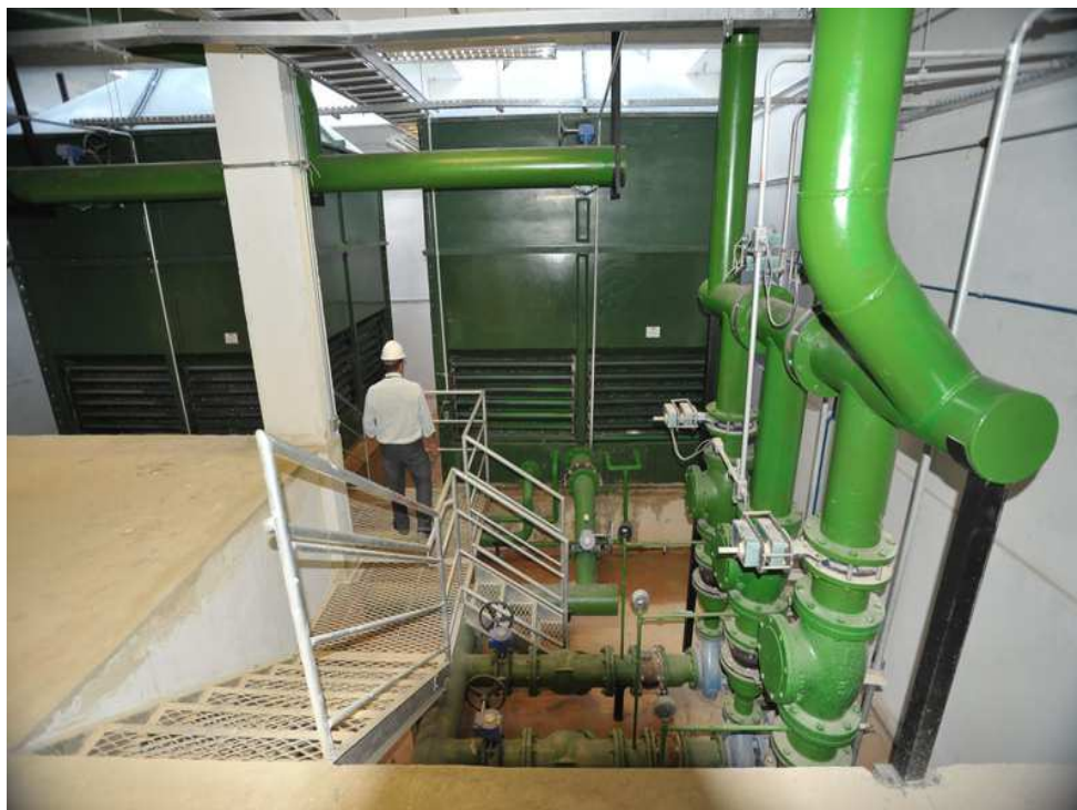
Figura 20 - Torres de Resfriamento instaladas na CAG do prédio do Palácio da CAMG - Foto: Acervo próprio
