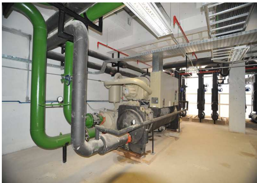
Figura 19 - Unidades Resfriadoras/ CAG do prédio do Palácio da CAMG - Foto: Acervo próprio
