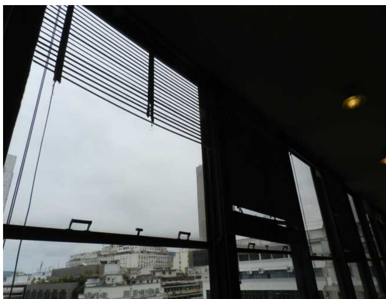
Figura 31 - Fachada Sudeste – Estado de conservação atual das Persianas ( nota-se que estas necessitam de reparação) Palácio Gustavo Capanema, Rio de Janeiro - Fonte: Acervo pessoal
