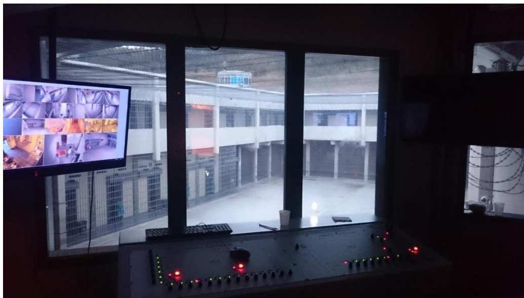
Fotografia 4 – Sala de monitoramento e controle
