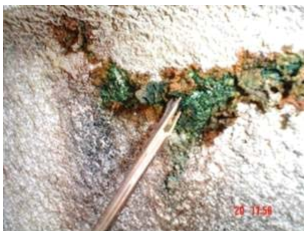
Figura 5.4 – Trinca com vazamento em parede lateral de cisterna.
