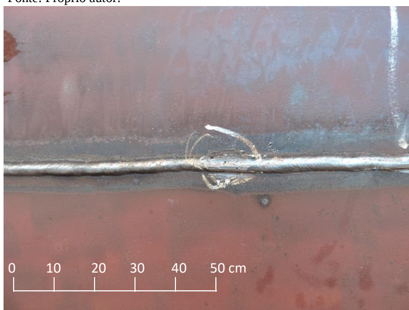
FIGURA 47: Poros em emenda de cordão identificados no RESERVATÓRIO ELEVADO 3.
