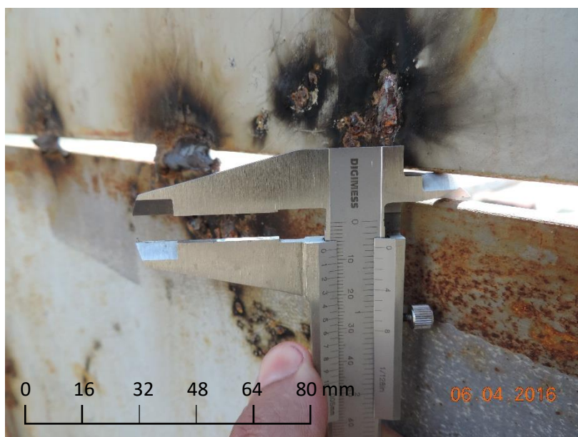
FIGURA 59: Abertura de 7 mm na junta identificada no RESERVATÓRIO ELEVADO 1.
