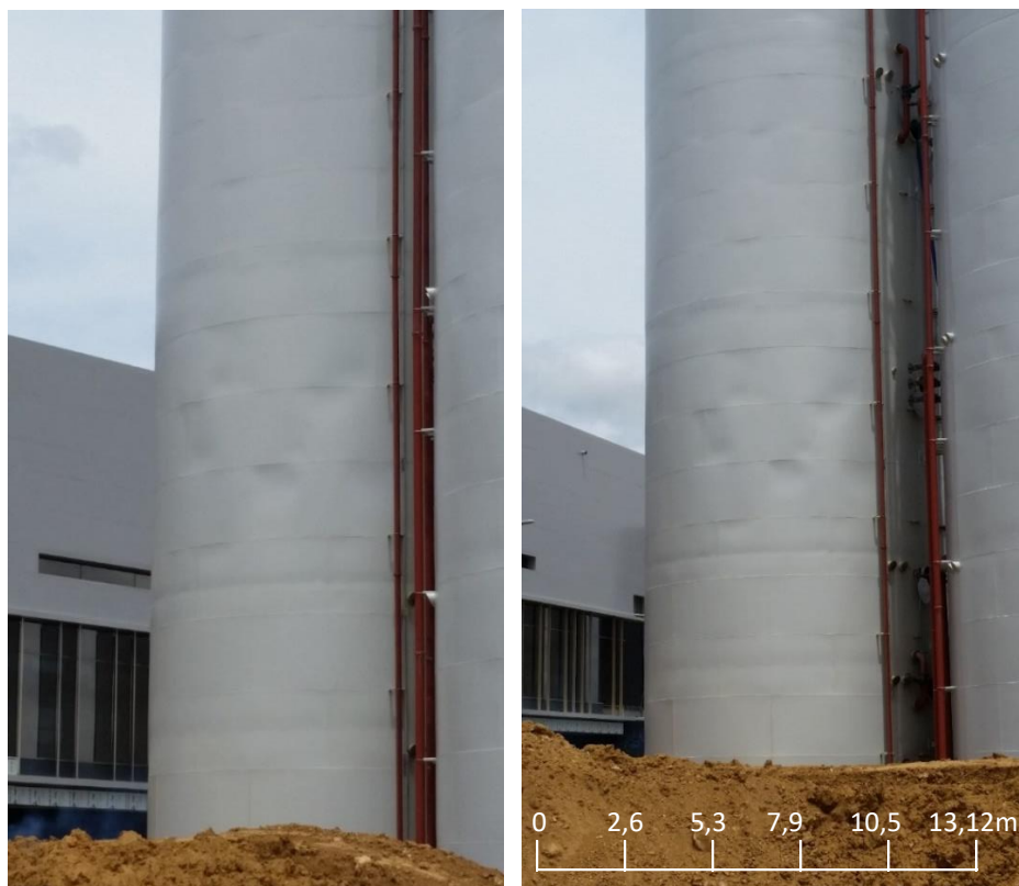
FIGURA 54: Deformações nas chapas após carregamento identificadas no TANQUE ELEVADO 4.
