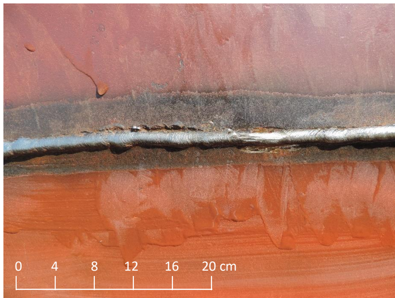
FIGURA 50: Mordeduras identificadas no RESERVATÓRIO ELEVADO 2.
