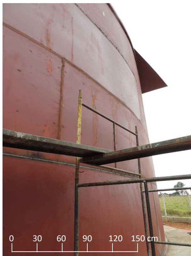
FIGURA 61: Deformações por contrações da solda identificada no RESERVATÓRIO APOIADO 3.
