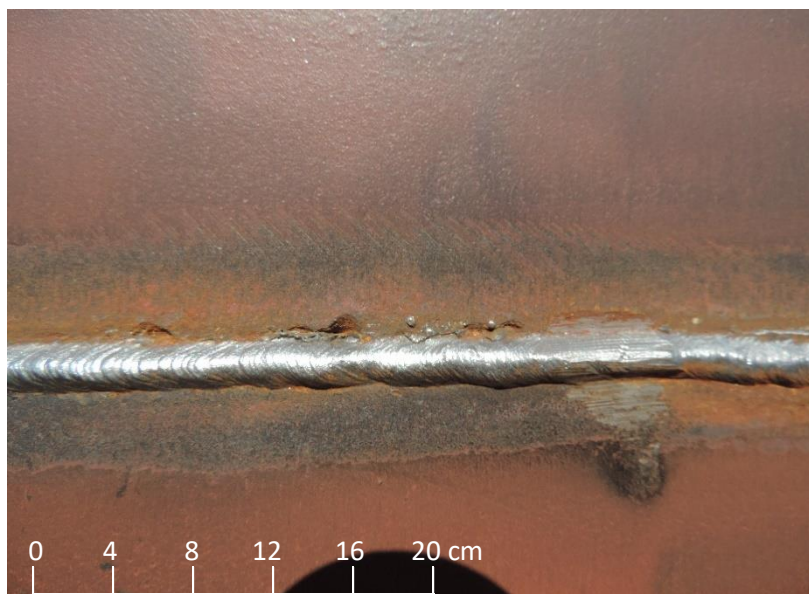
FIGURA 51: Mordeduras identificadas no RESERVATÓRIO ELEVADO 2.
