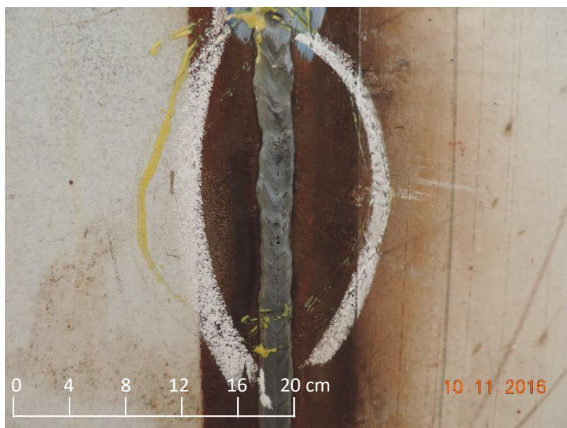
FIGURA 48: Poros por oxidação identificados no RESERVATÓRIO ELEVADO 6.
