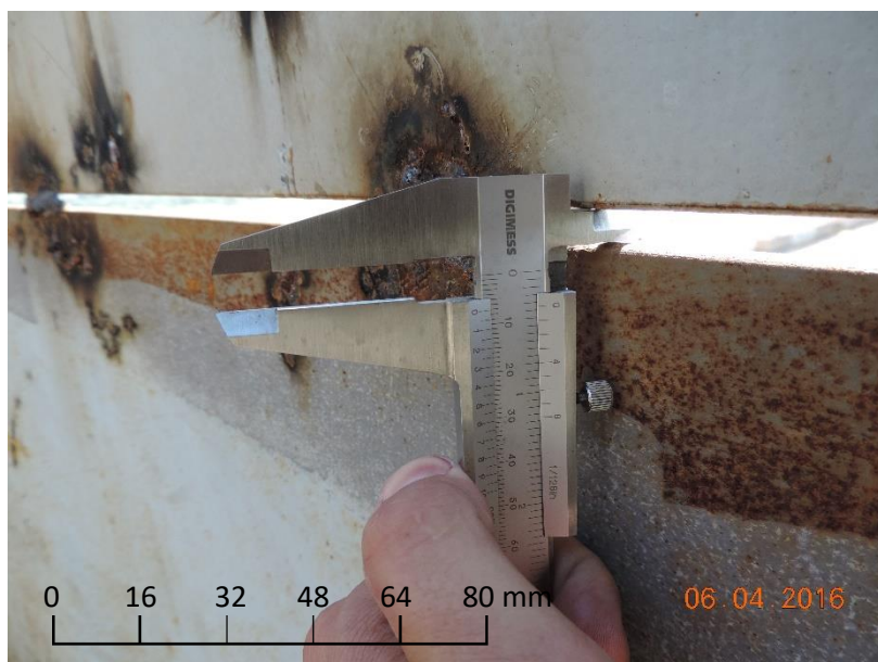
FIGURA 58: Abertura de 7 mm na junta identificada no TANQUE ELEVADO 1.
