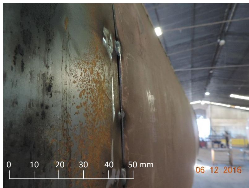
FIGURA 56: Desalinhamento entre chapas identificada no RESERVATORIO ELEVADO 5.
