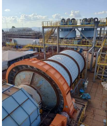
Figura 2 - Circuito com moagem reversa na empresa Mineração Morro do Ipê, (Mineração Morro do Ipê, 2023).
