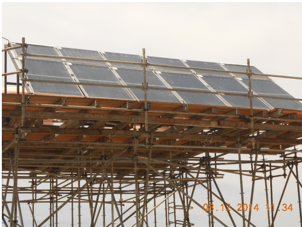
Figura 5 Painéis de coleta de energia solar.
