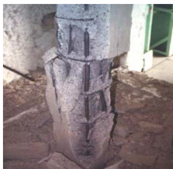
Figura 2.2 – Exemplo de spalling explosivo ocorrido em pilar de concreto f_{ck} igual a 83 MPa (Kodur, 2005).
