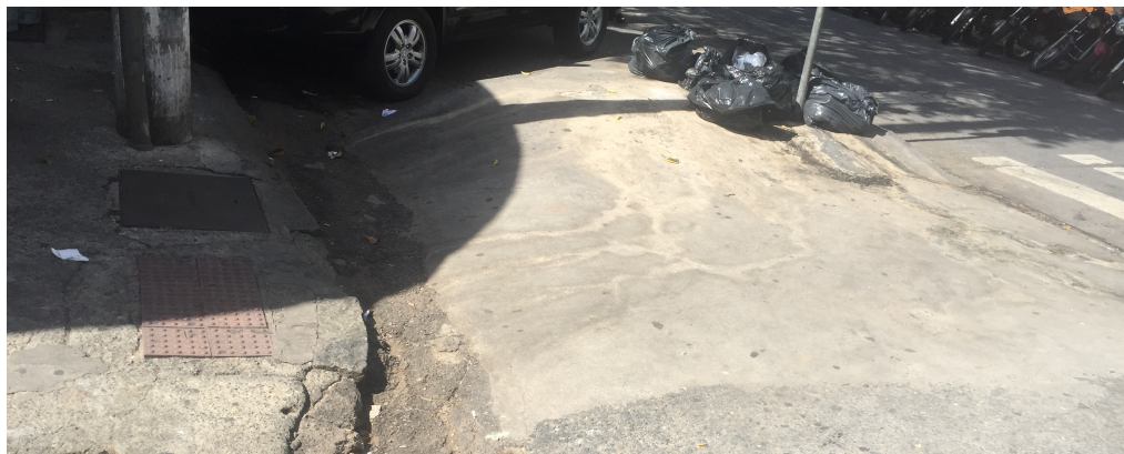
Figura 13. Rebaixamento de calçada que impede um cadeirante de atravessar a rua.
