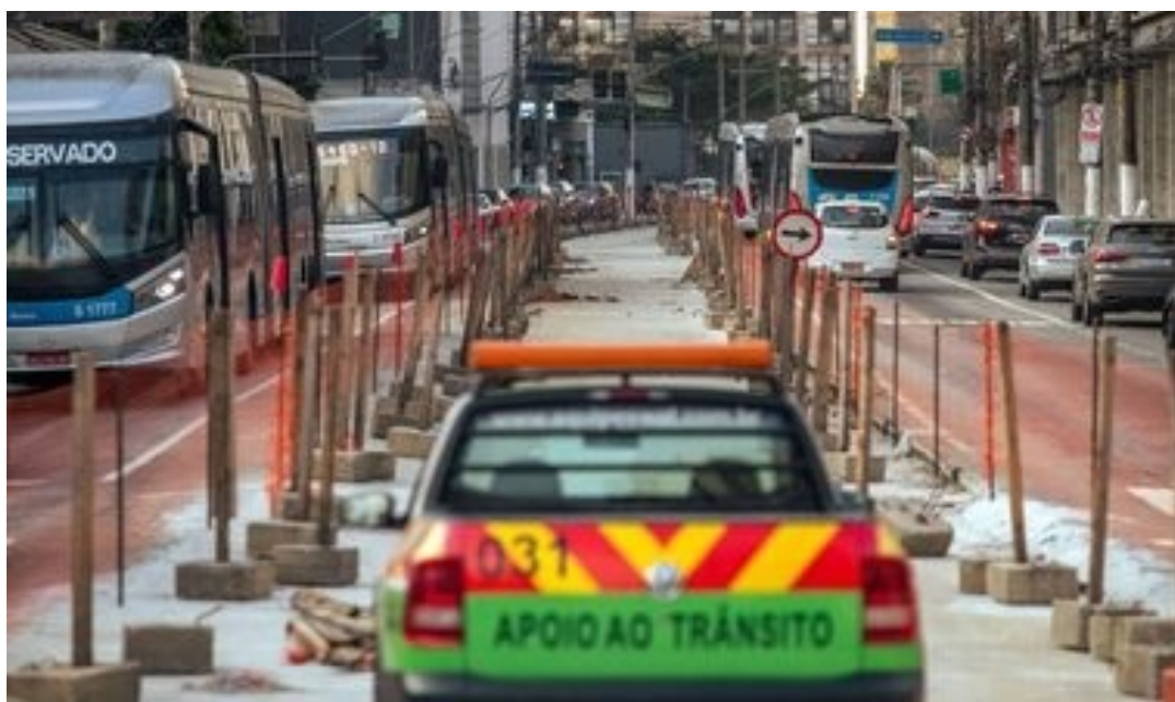
Fotografia 63 - Situação da avenida Santo Amaro durante os quase dois anos de obra
