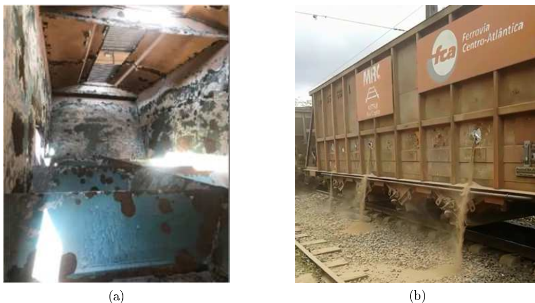
Figura 3.1. (a) Pintura Interna Corroída; (b) Vazamento de Produto nos Furos Laterais. Fonte:[VLI, 2018].
