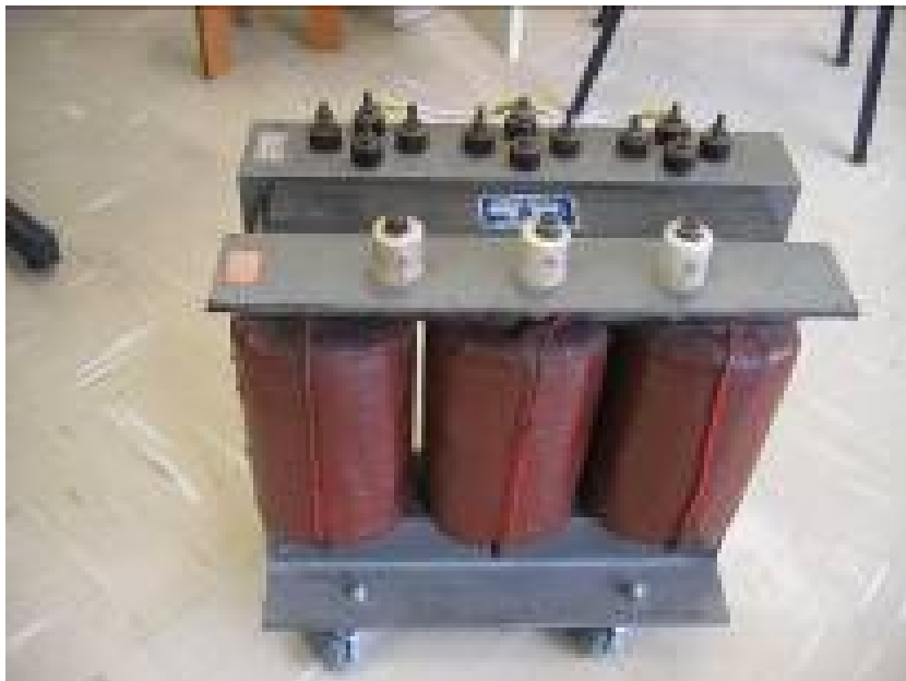
Figura 71: Transformador utilizado nos ensaios de indução de faltas.
