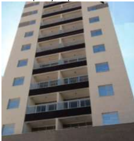
Figura 14 Edifício Residencial Multifamiliar (Belo Horizonte/MG) com destaque para os dispositivos de proteção tipo venezianas
