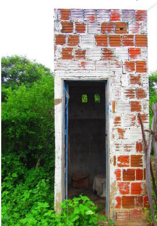
Figura 5.23: Módulo sanitário em estado de precariedade
