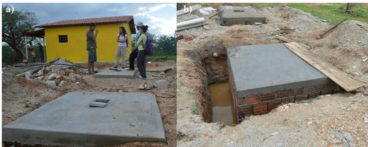
a) Sistema tanque séptico e sumidouro em uma das casas que estão sendo construídas; b) Sumidouro cheio de água de chuva, indicando como o solo da região dificulta a infiltração do efluente.
