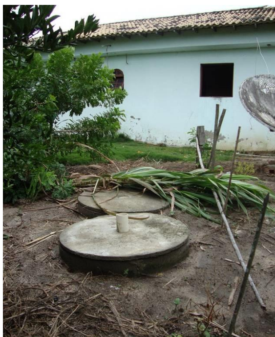
Figura 5.52: Fossa e filtro localizados em uma das casas
