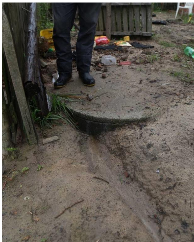
Figura 5.48: Fossa de um dos moradores apresentando extravasamento
